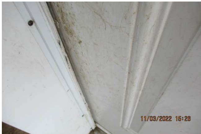
Joint d'étanchéité de la porte extérieure endommagée
