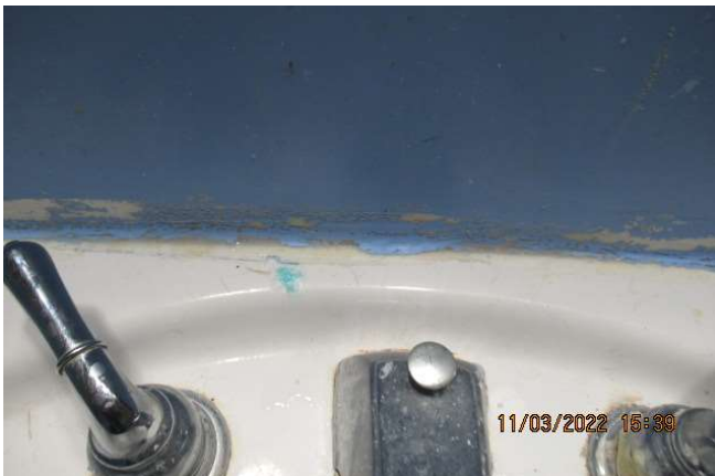
Revêtement de finition endommagé derrière les robinets de l'évier
