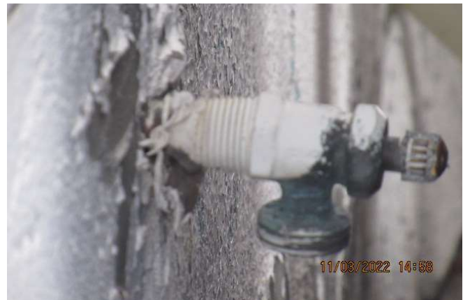
Robinet extérieur sans protection contre le gel
