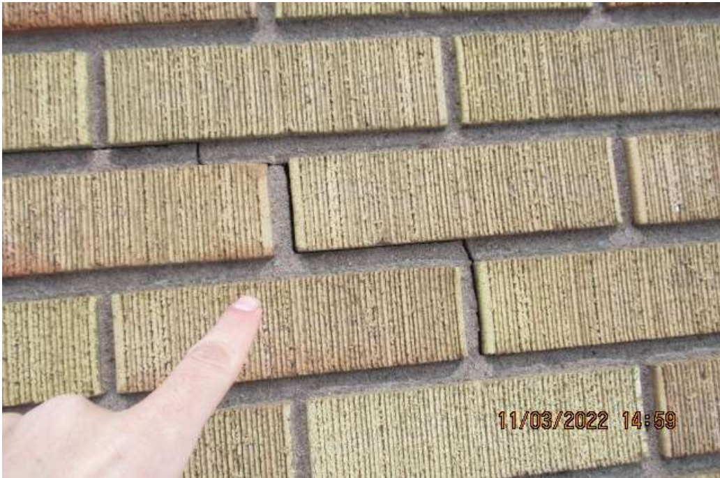
Fissures et ouverture dans le mortier
