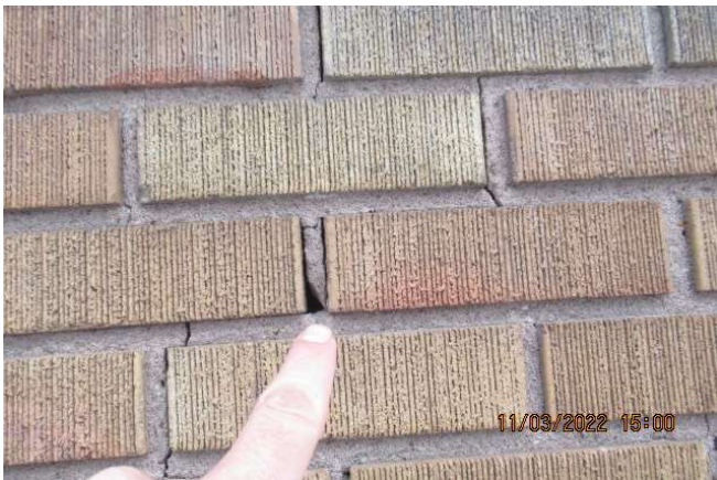
Fissures et ouverture dans le mortier
