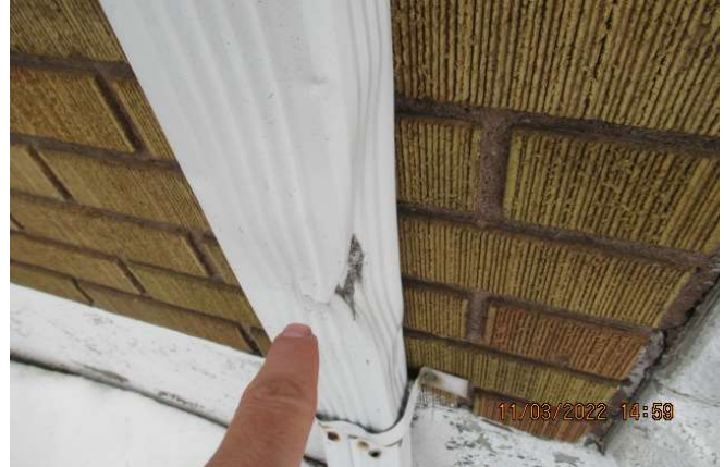
Descente pluviale mal fixée et endommagée
