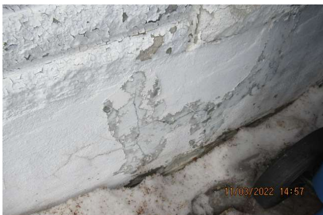
Fissures sur la fondation
