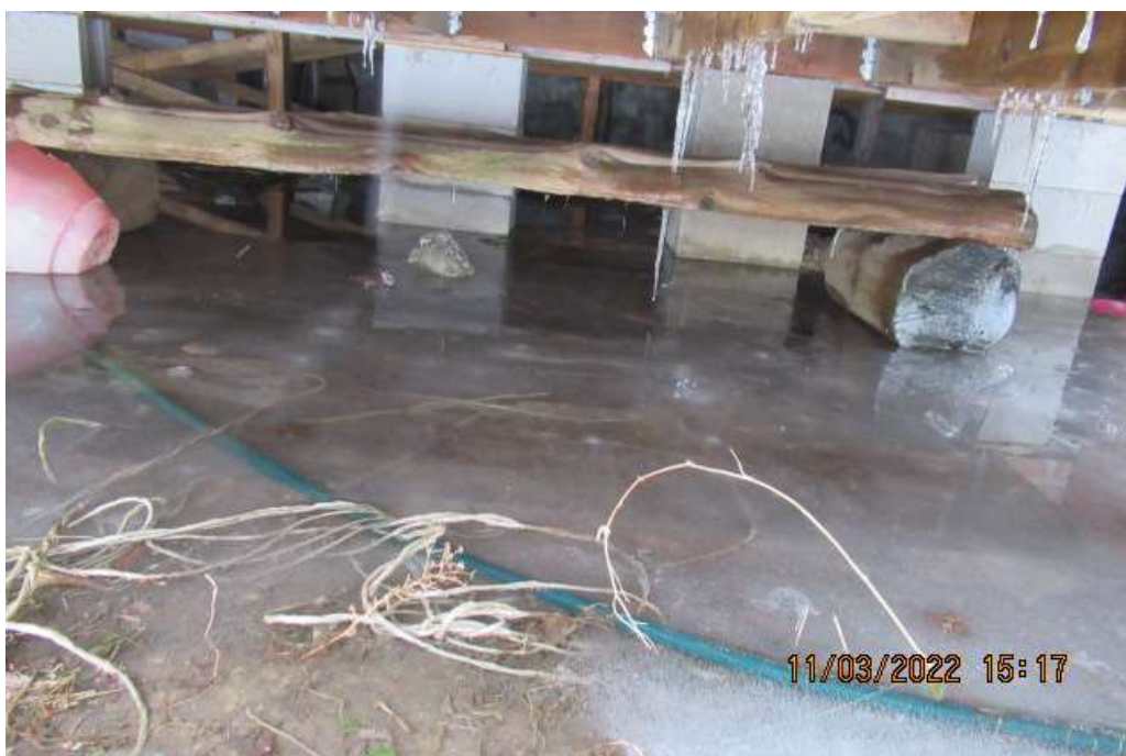
Accumulation de glace près de la fondation
