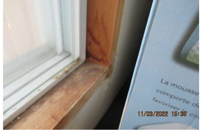
Fenêtres âgées et dommage sur le cadre de fenêtre en bois
