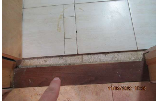
Joint de transition absent sur le plancher
