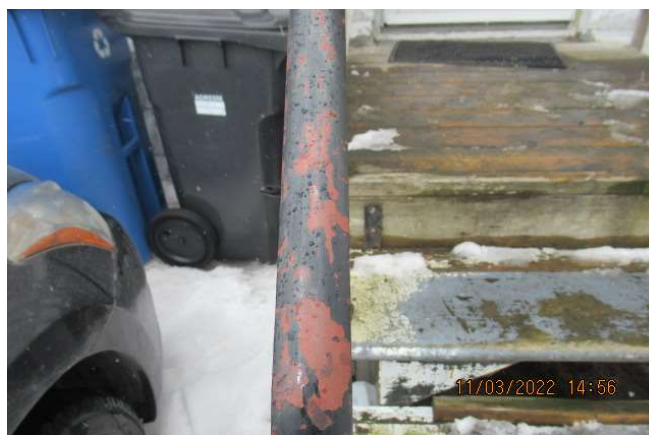
Balustrades d'acier qui nécessite une peinture de protection.
