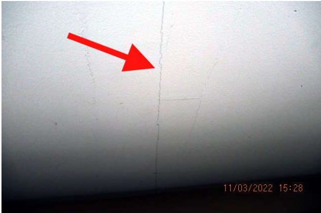
Fissures sur le mur de gypse.
