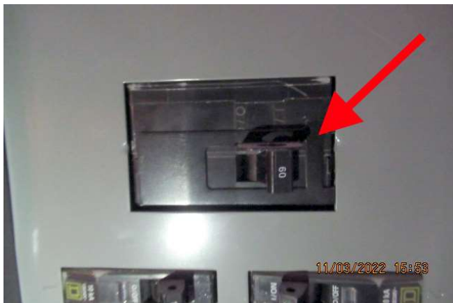
Disjoncteur de faible capacité pour une maison unifamiliale
