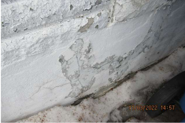
Défauts sur le crépi
