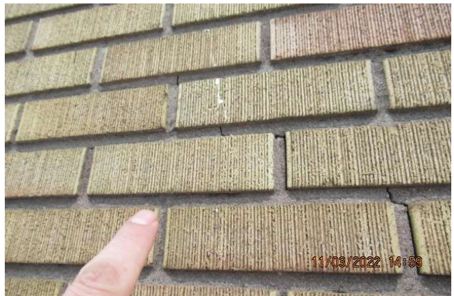
Fissures et ouverture dans le mortier
