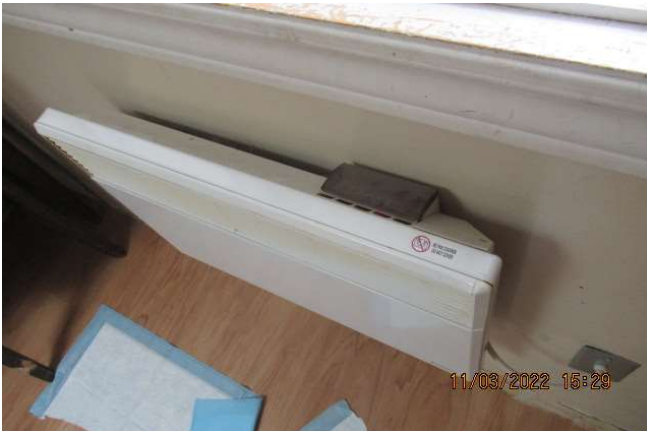
Aucune déficience apparente aux convecteur électriques
