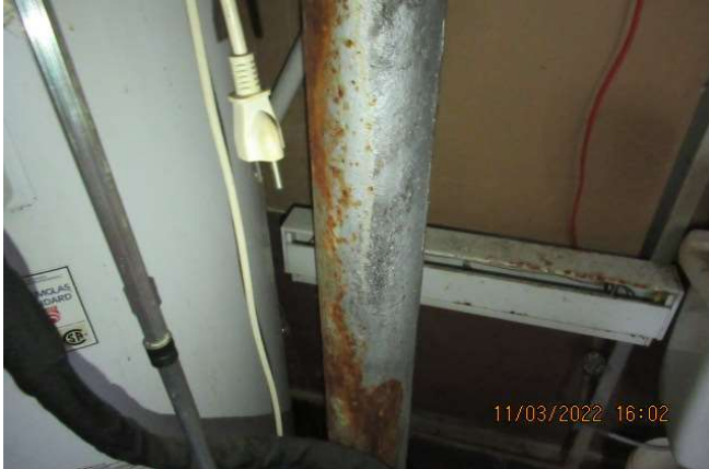
Tuyau d'évacuation en fonte à changer
