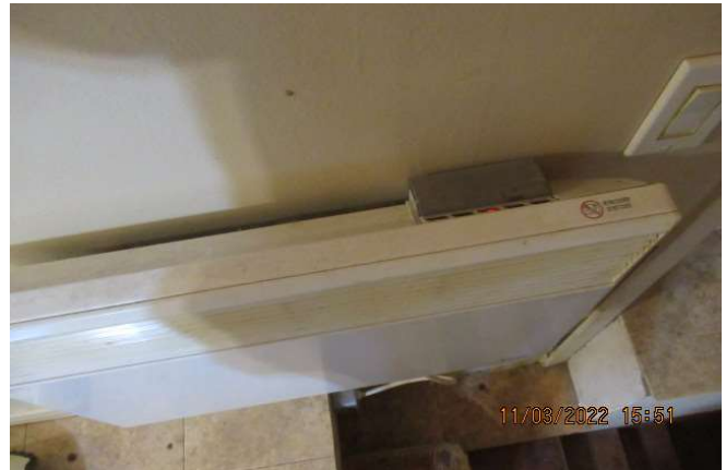
Aucune déficience apparente aux convecteur électriques
