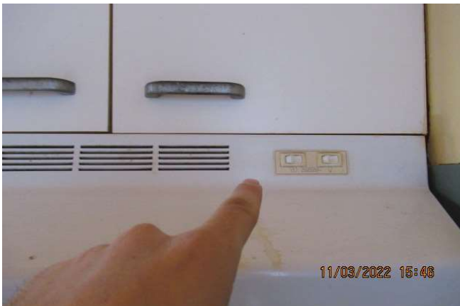
Ventilateur de cuisinière défectueux
