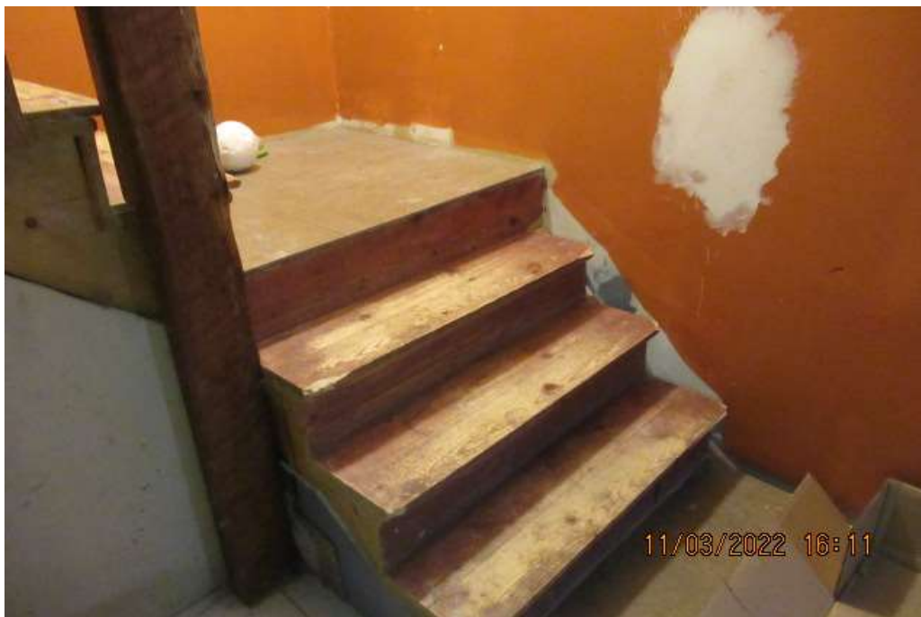
Absence d'une main-courante continue
