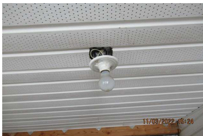
Luminaire extérieur sans globe de protection
