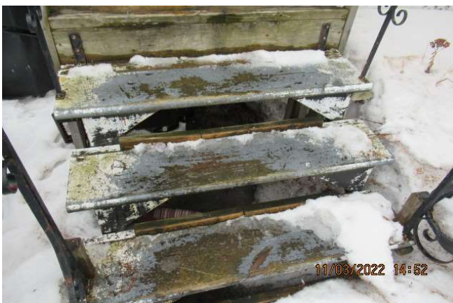
Marche de l'escalier pourrie
