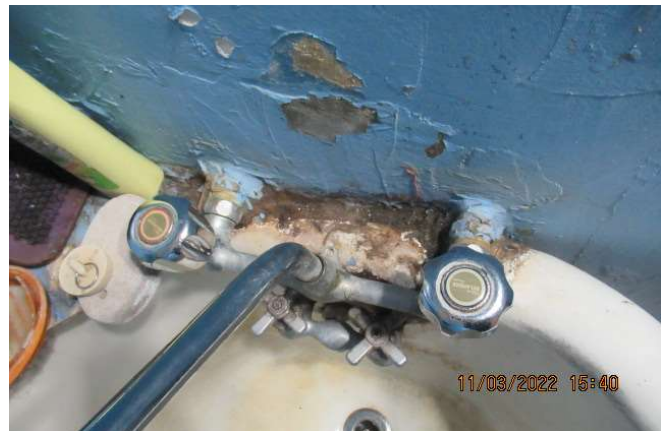
Revêtement de finition endommagé derrière les robinets de l'évier
