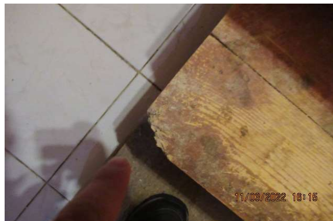
Escalier en bois usé et endommagé
