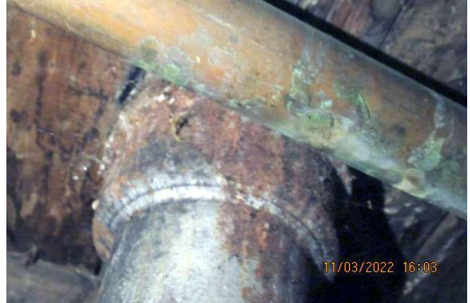
Tuyau d'évacuation en fonte à changer
