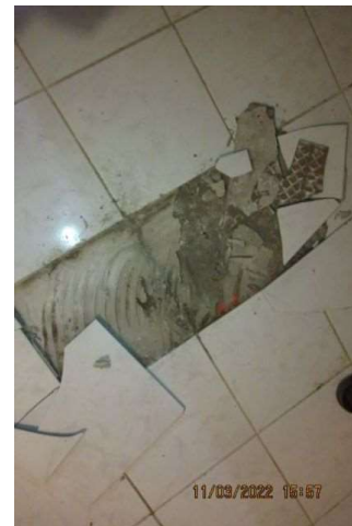
Dompage du revêtement de sol
