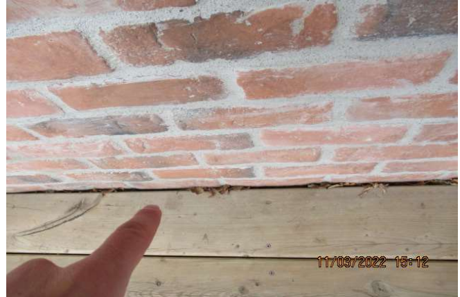
Solin et scellant absent le long de la terrasse et du mur
