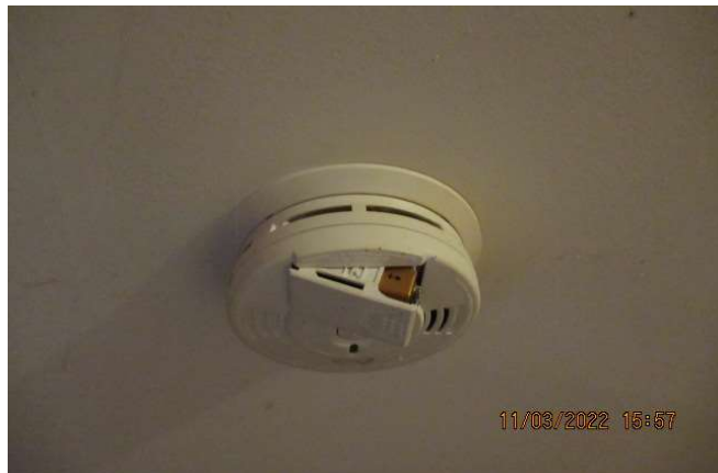
Avertisseur de fumée défectueux
