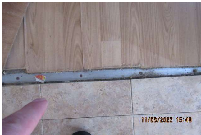
Joint de transition absent sur le plancher
