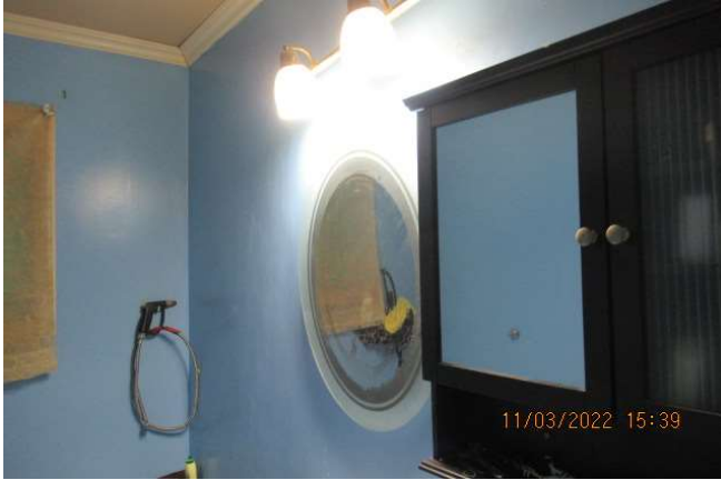
Absence de ventilateur
