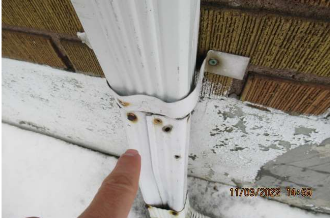
Descente pluviale mal fixée et endommagée
