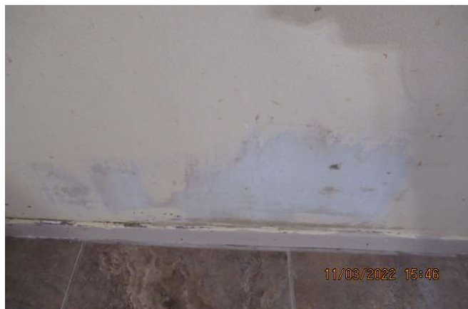
Revêtement de finition endommagé
