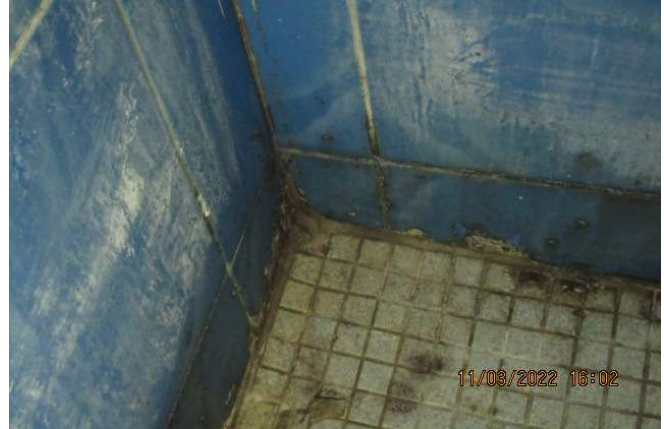
Trace s'apparentant à de la moisissure au pourtour de la douche
