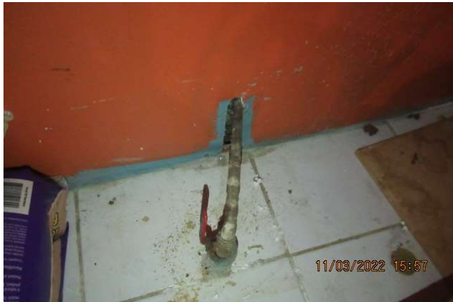
Mise à la terre non visible
