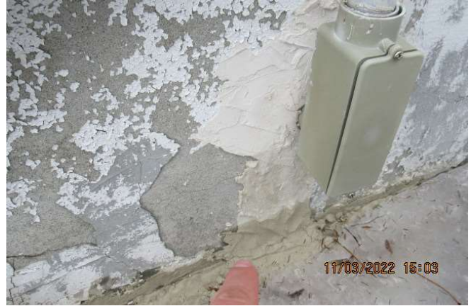
Défauts sur le crépi
