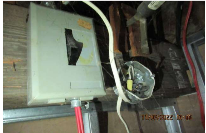
Raccordement électrique artisanale
