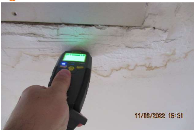
Cernes d'eau au plafond
