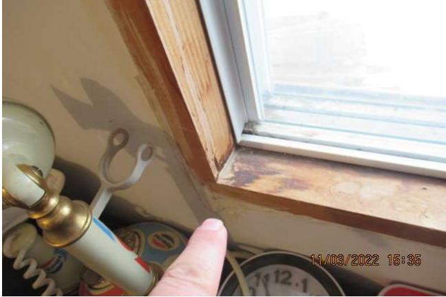
Fenêtres âgées et dommage sur le cadre de fenêtre en bois
