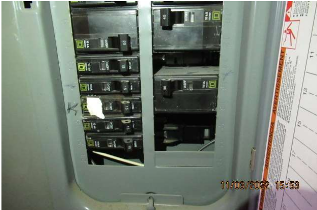
Ouvertures non scellées dans le panneau de distribution
