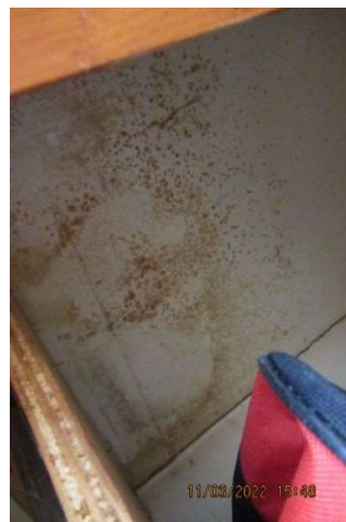
Revêtement de finition endommagé
