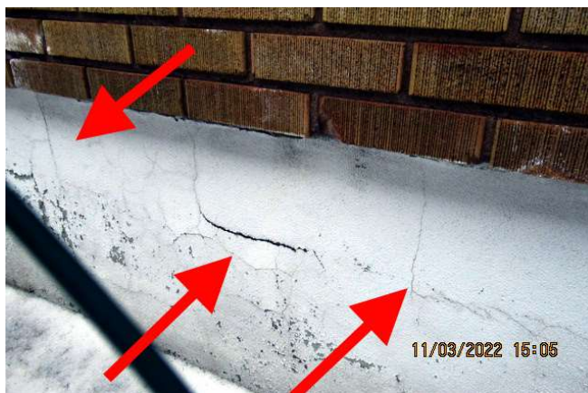
Fissures sur la fondation
