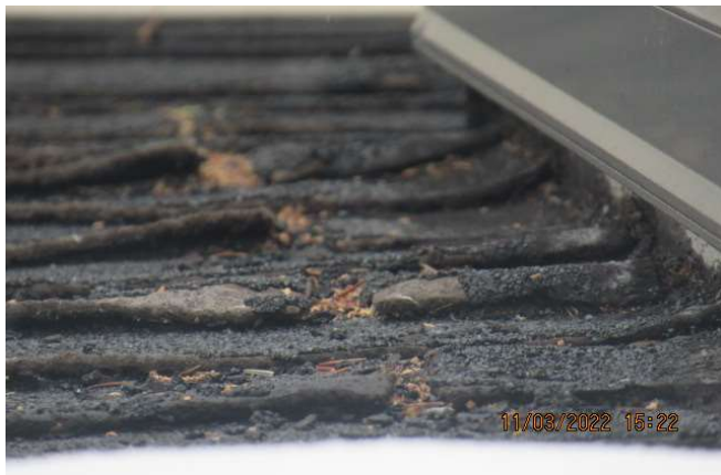
Revêtement de bardeaux d'asphalte détérioré
