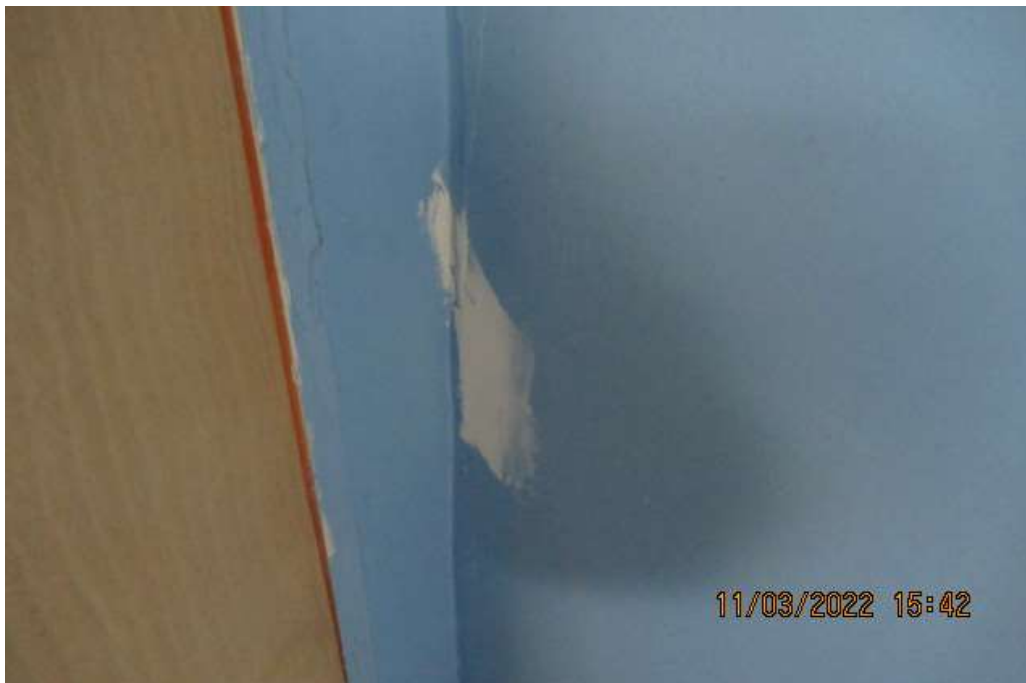
Revêtement de finition endommagé
