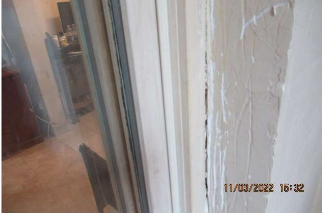
Revêtement de finition endommagé
