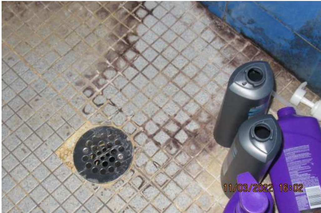
Trace s'apparentant à de la moisissure au pourtour de la douche
