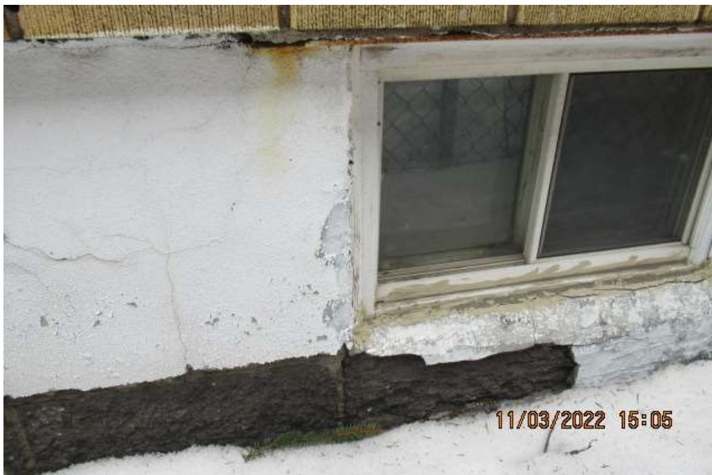
Défauts sur le crépi
