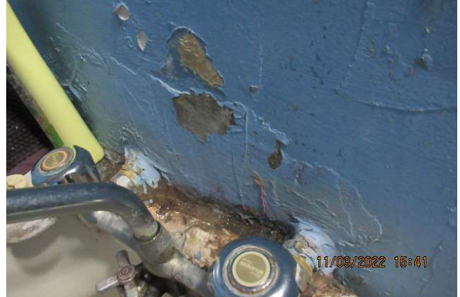
Revêtement de finition endommagé
