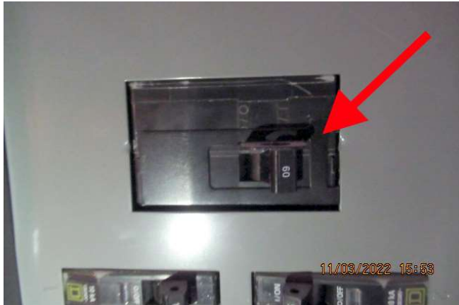
Panneau de distribution à remplacer
