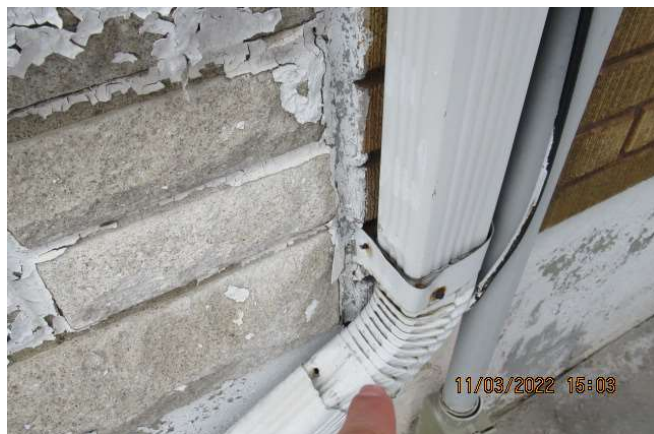
Descente pluviale mal fixée et endommagée
