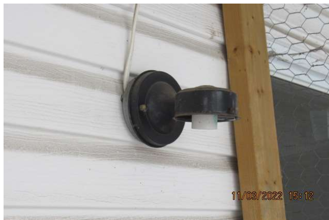
Luminaire extérieur mal fixé et mal scellé
