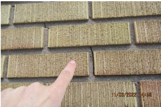
Fissures et ouverture dans le mortier
