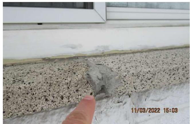
Fissure au joint de l'allège jointoyée
