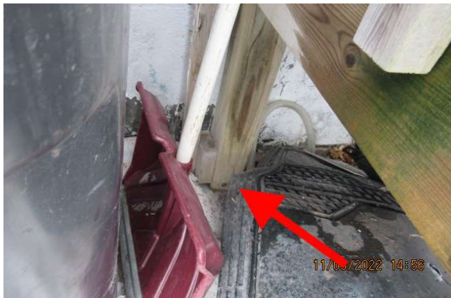
Escalier en bois reposant directement sur le sol
