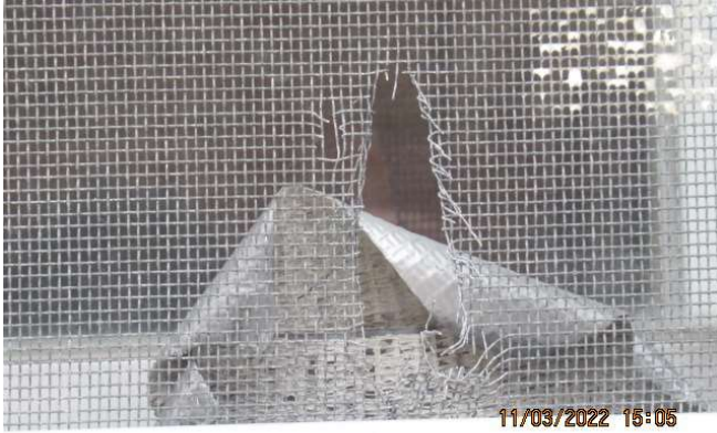
Moustiquaire de la fenêtre déchiré
