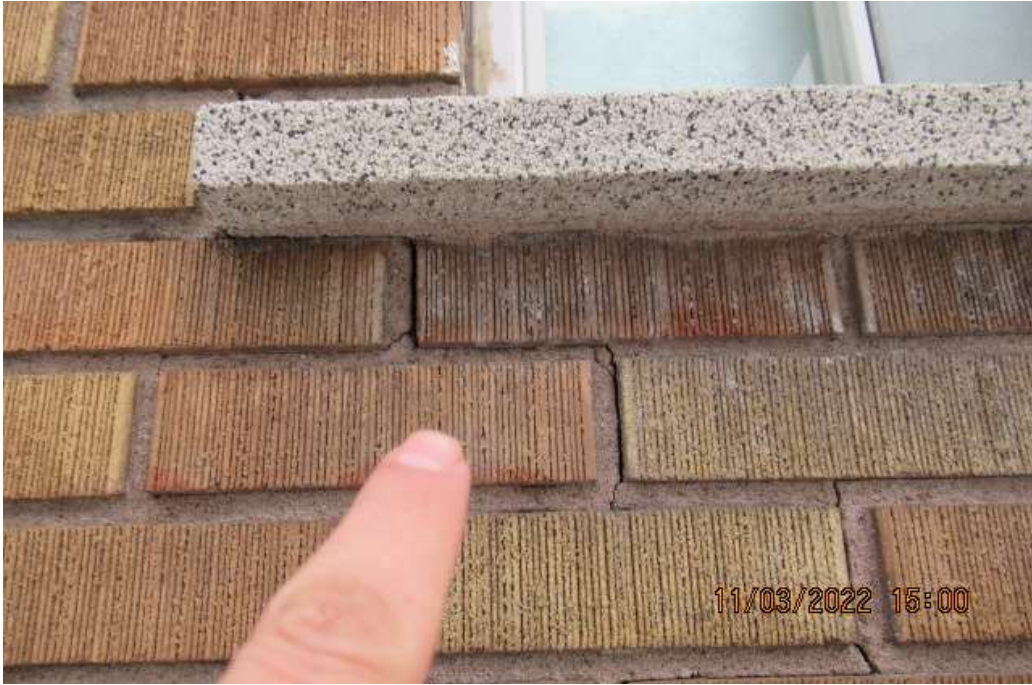
Fissures et ouverture dans le mortier
