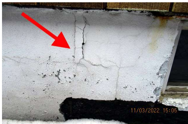
Fissures sur la fondation
