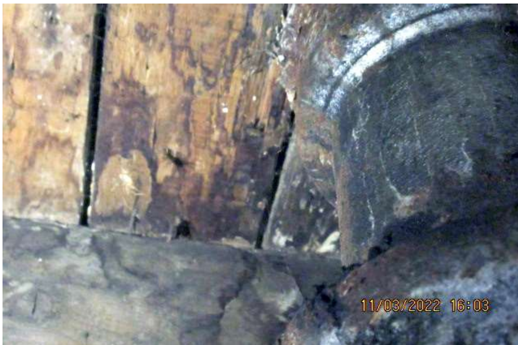
Tuyau d'évacuation en fonte à changer
