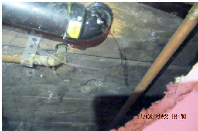
Solive de rives cernées par l'eau
