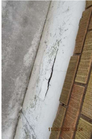
Défauts sur le crépi
