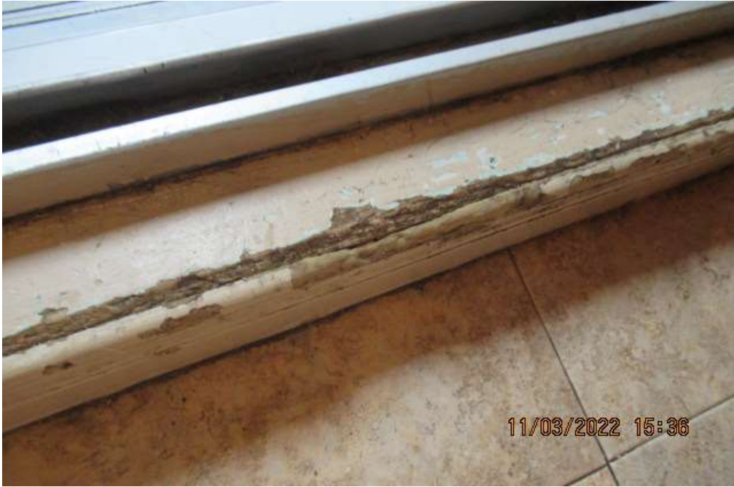
Domage du revêtement de sol
