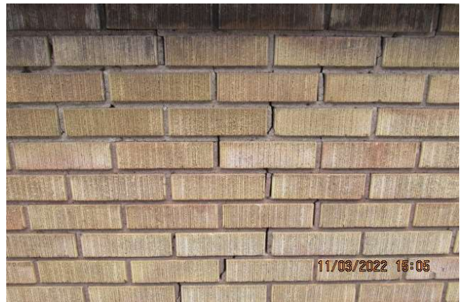
Fissures et ouverture dans le mortier
