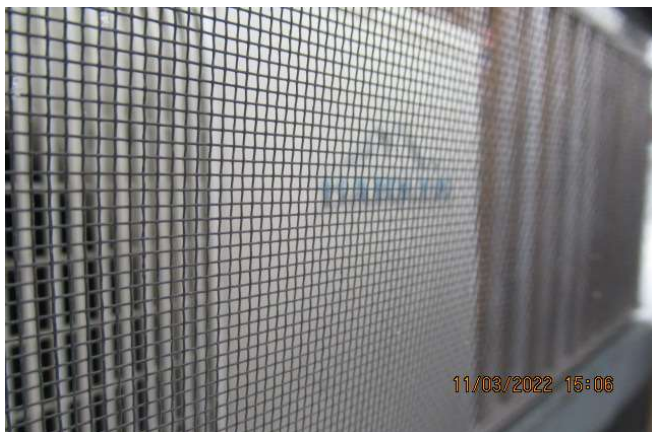
Installation artisanale du climatiseur
