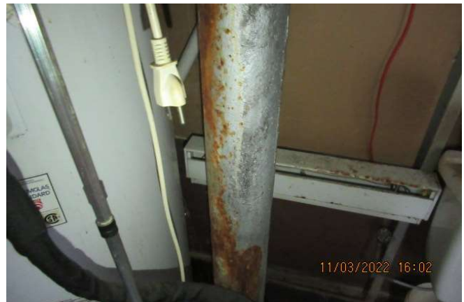
Tuyau d'évacuation en fonte à changer
