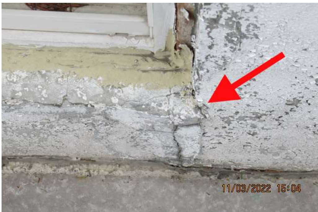
Fissures sur la fondation
