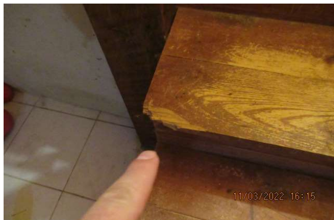
Escalier en bois usé et endommagé
