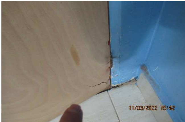
Dommages et ouverture dans une porte
