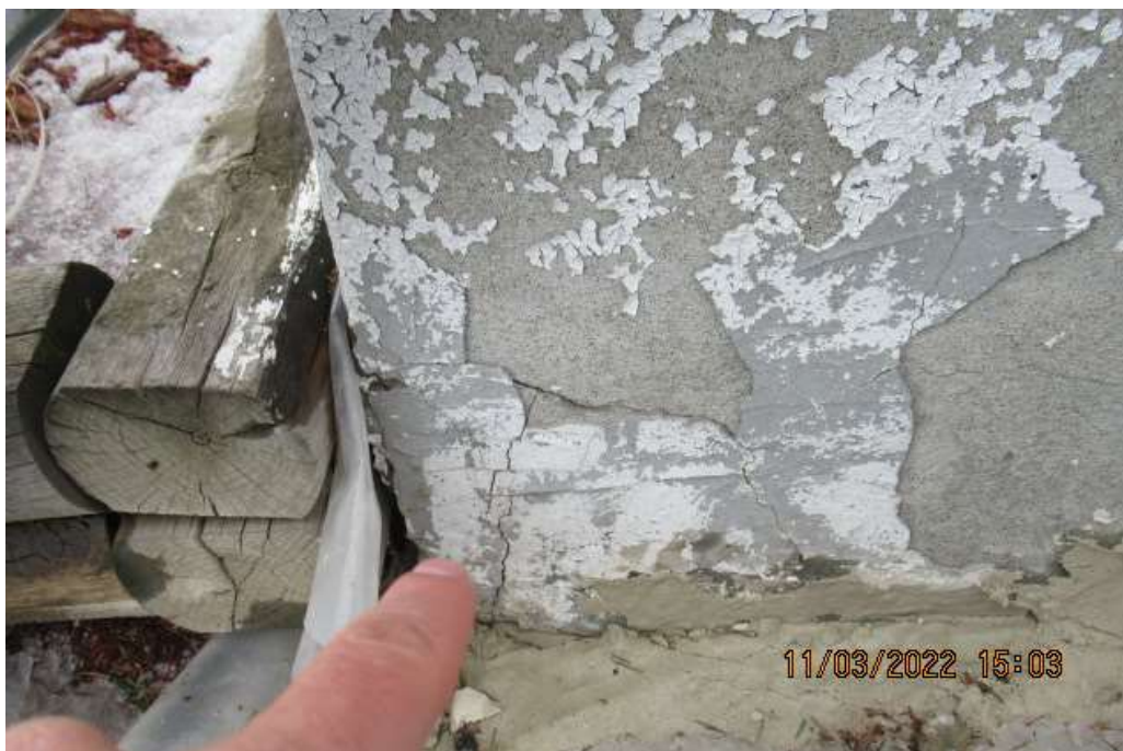
Défauts sur le crépi
