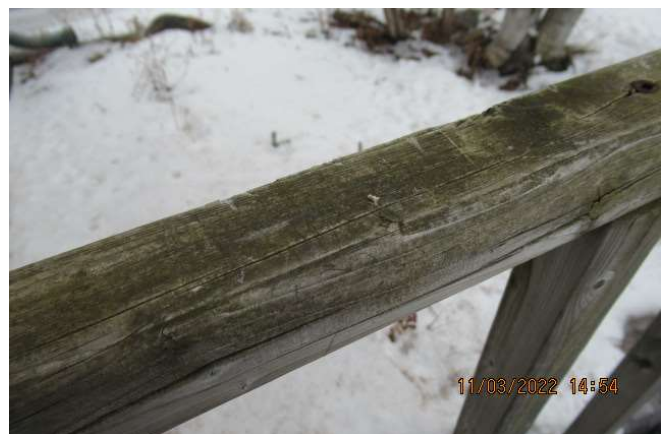
Marche de l'escalier pourrie
