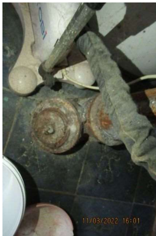
Tuyau d'évacuation en fonte à changer
