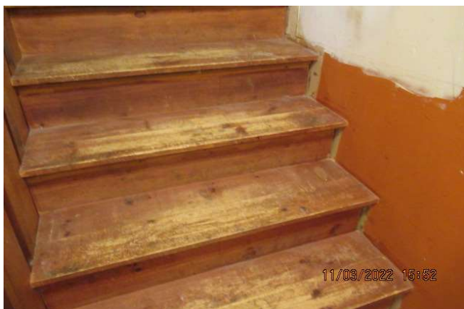
Absence d'une main-courante continue
