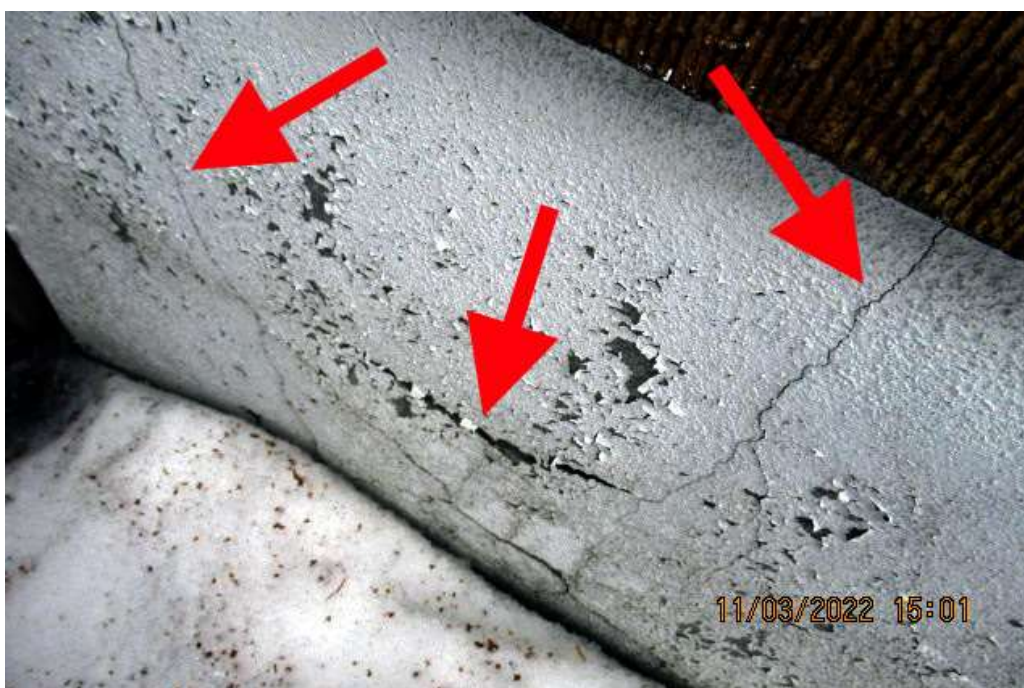
Fissures sur la fondation
