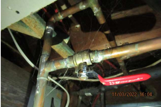
Conduites de cuivre âgées
