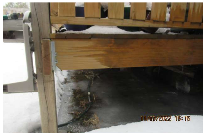
Accumulation de glace près de la fondation
