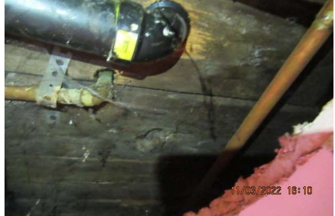
Conduites de cuivre âgées
