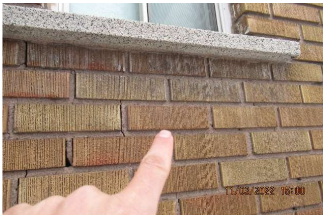
Efflorescence sur le mur de maçonnerie
