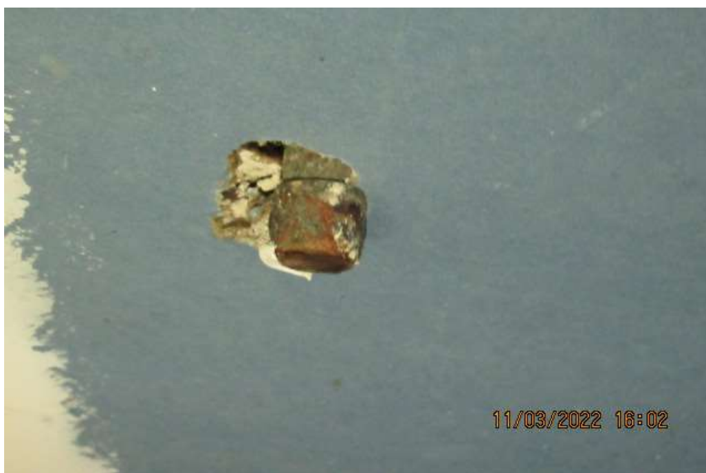
Revêtement de finition endommagé
