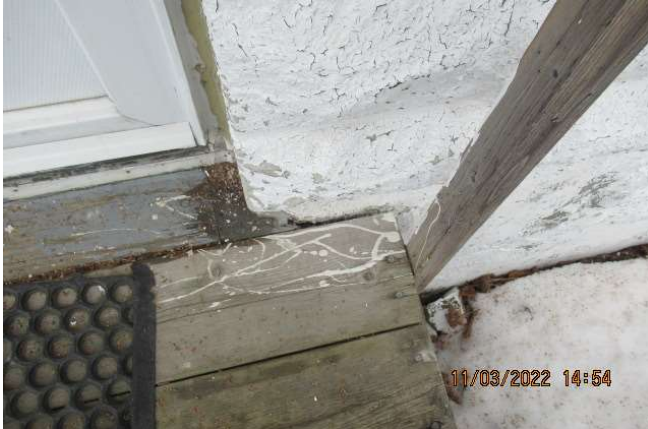
Solin et scellant absent le long de la terrasse et du mur
