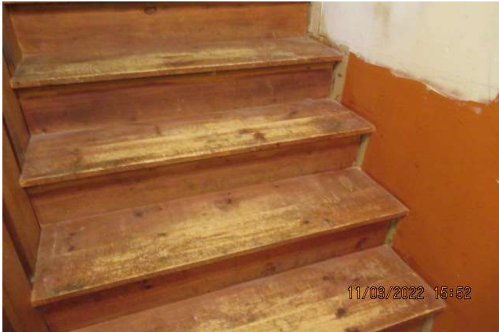
Escalier en bois usé et endommagé
