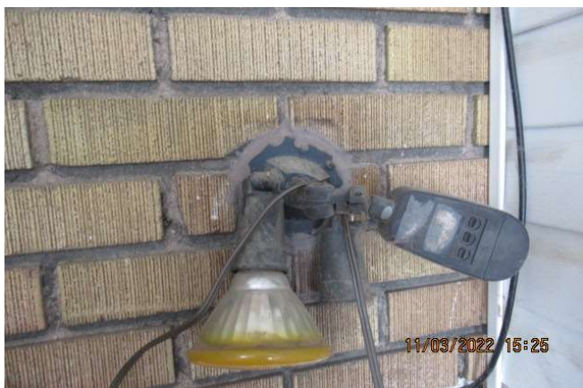
Luminaire extérieur à remplacer
