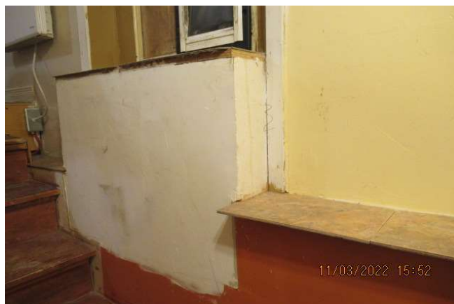
Absence d'une main-courante continue
