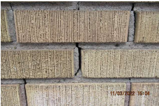
Fissures et ouverture dans le mortier
