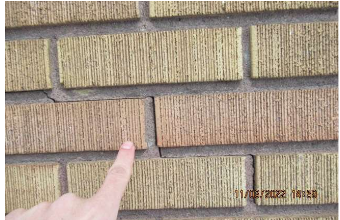
Fissures et ouverture dans le mortier
