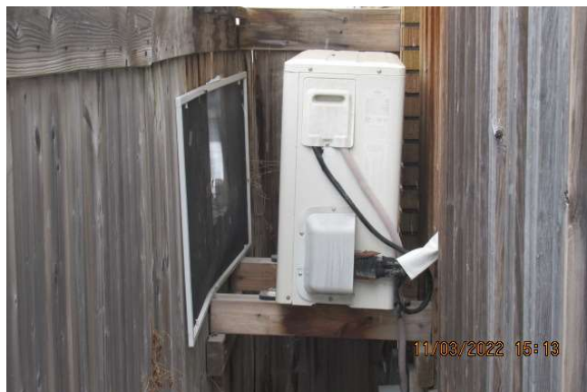
Installation artisanale du climatiseur
