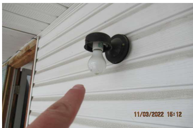
Luminaire extérieur sans globe de protection
