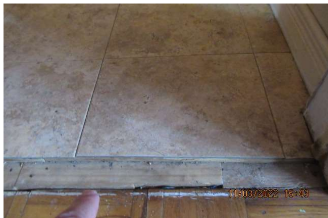
Joint de transition absent sur le plancher
