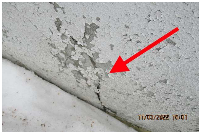
Fissures sur la fondation
