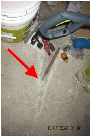
Taches s'apparentant à de l'efflorescence sur la dalle de béton
