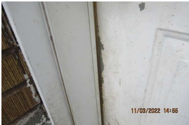
Joint d'étanchéité de la porte extérieure endommagée
