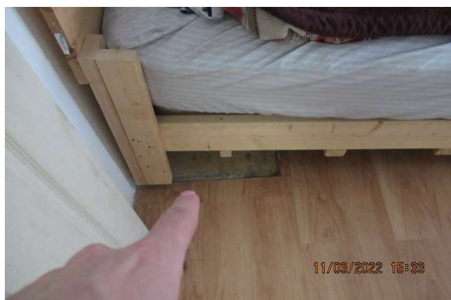
Domage du revêtement de sol
