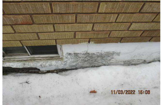
Défauts sur le crépi
