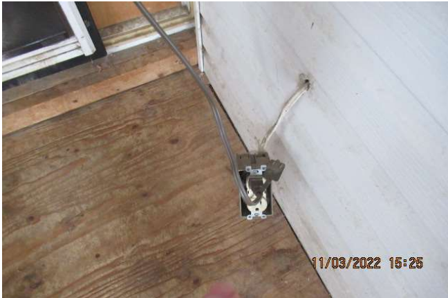
Branchement artisanal d'une prise de courant extérieur sans DDFT
