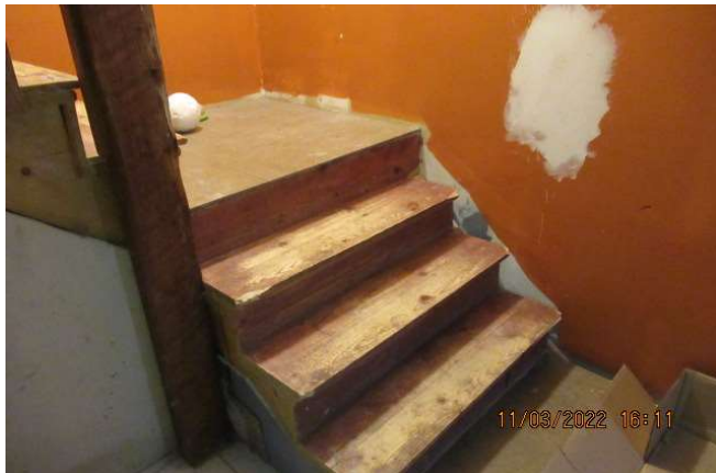
Absence de garde-corps sur le côté non protégé de l'escalier
