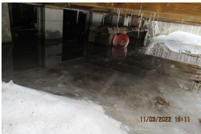
Accumulation de glace près de la fondation
