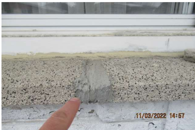
Fissure au joint de l'allège jointoyée
