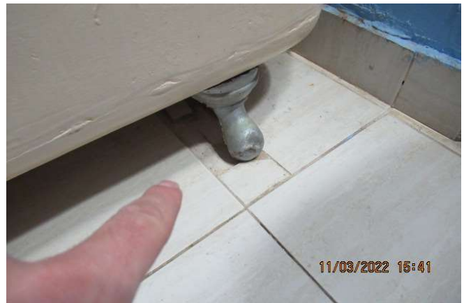
Domage du revêtement de sol
