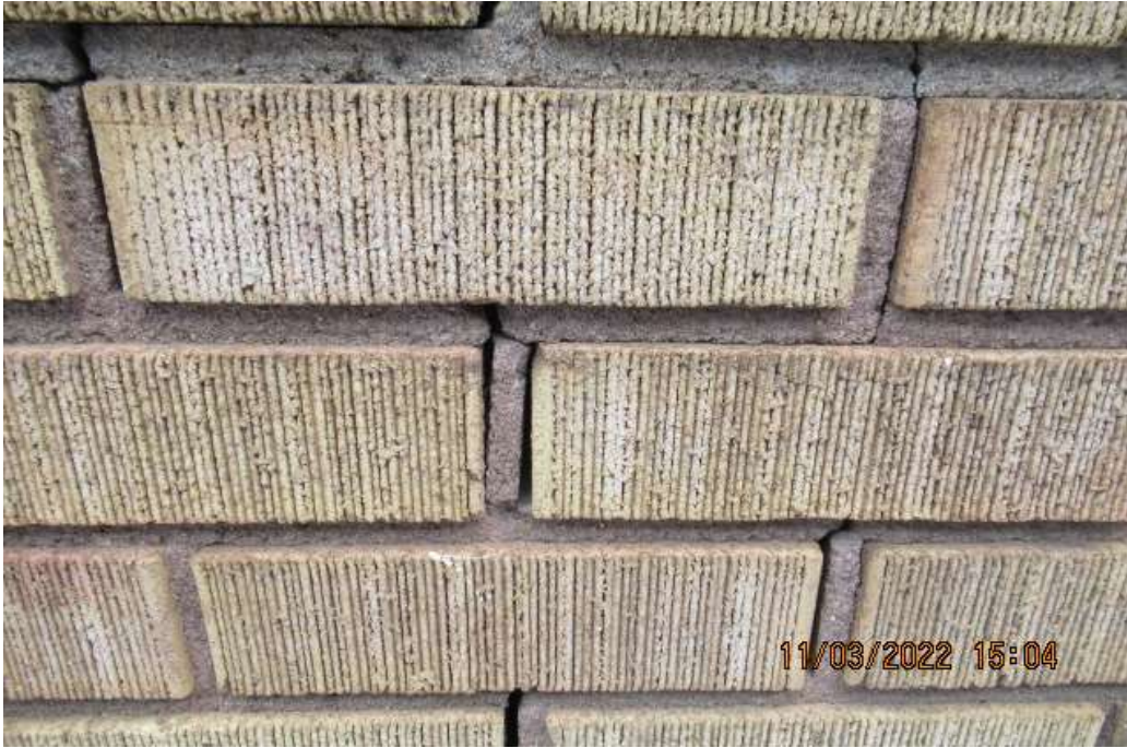
Fissures et ouverture dans le mortier
