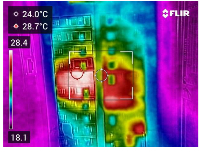
Disjoncteur partagé qui surchauffe sur le panneau de distribution
