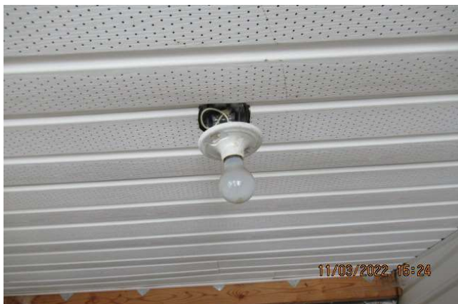
Luminaire extérieur mal fixé et mal scellé
