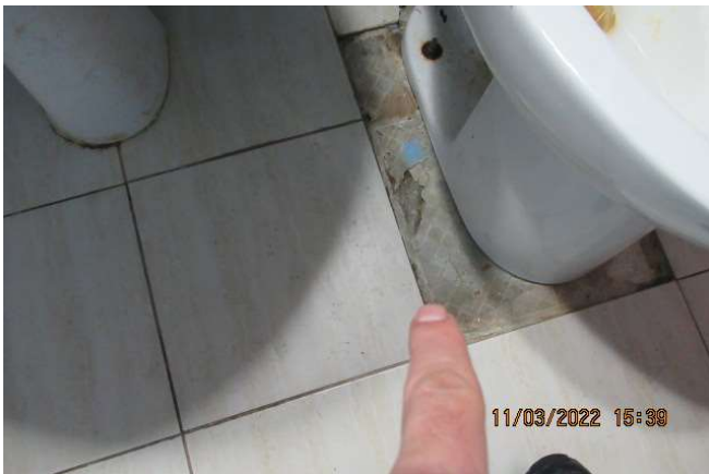
Domage du revêtement de sol
