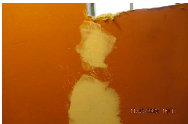
Revêtement de finition endommagé
