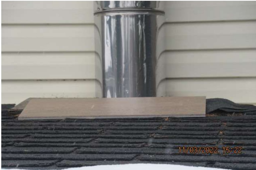
Solins du toit a vérifier et a sceller
