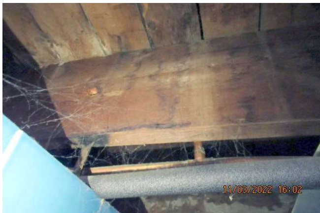
Solive de rives cernées par l'eau
