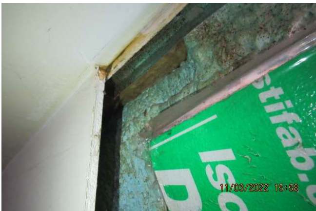
Cernes s'apparentant à de la moisissure sur l'isolant
