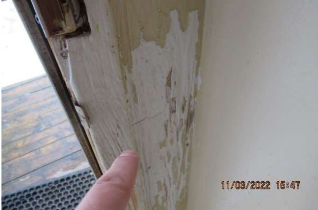
Trace d'eau et cerne sur le mur de l'entrée principale
