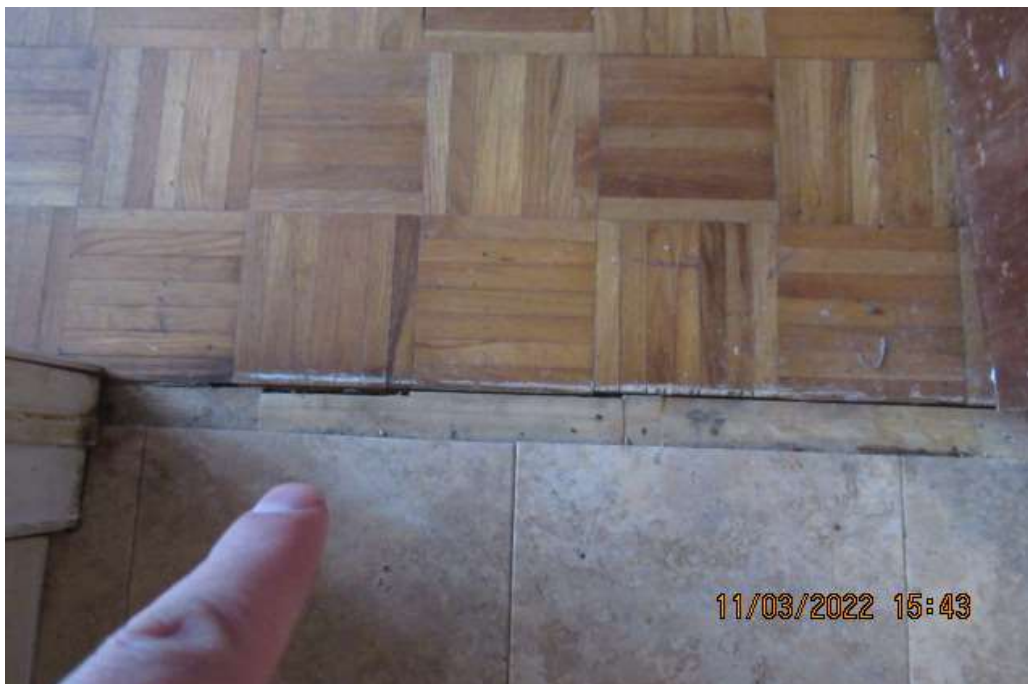
Joint de transition absent sur le plancher
