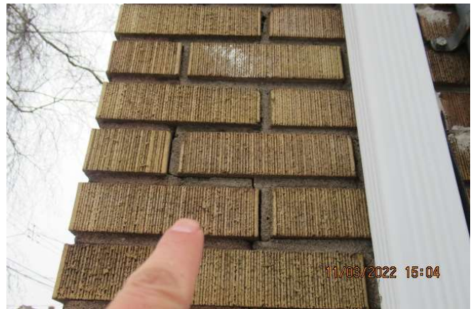
Fissures et ouverture dans le mortier
