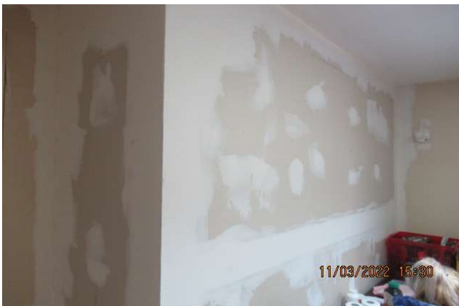
Finition des murs à compléter
