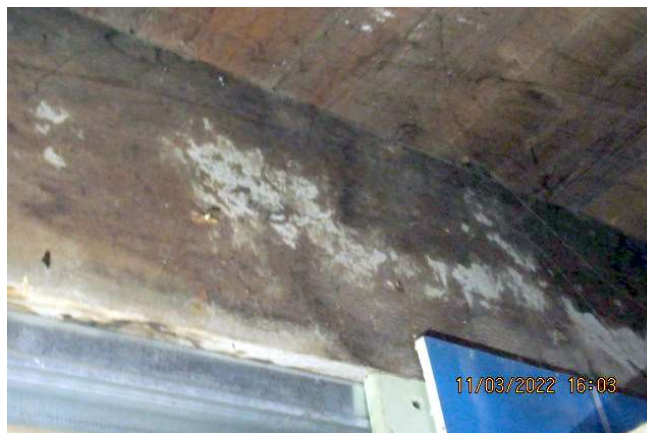
Solive de rives cernées par l'eau
