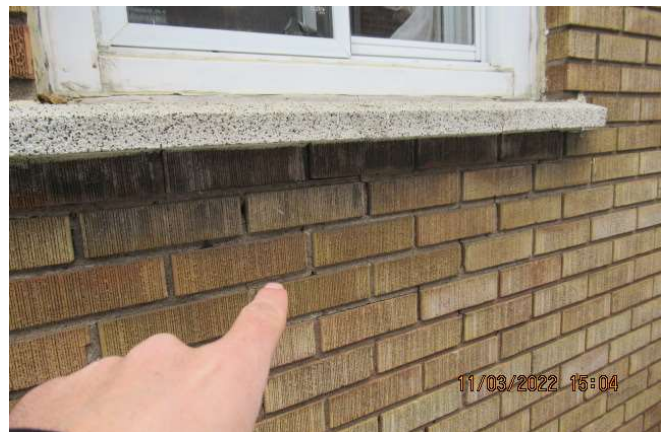
Efflorescence sur le mur de maçonnerie
