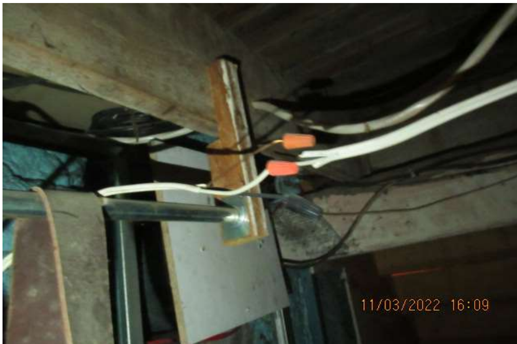
Raccordement électrique artisanale
