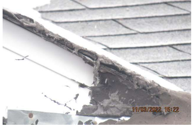
Solins du toit a vérifier et a sceller
