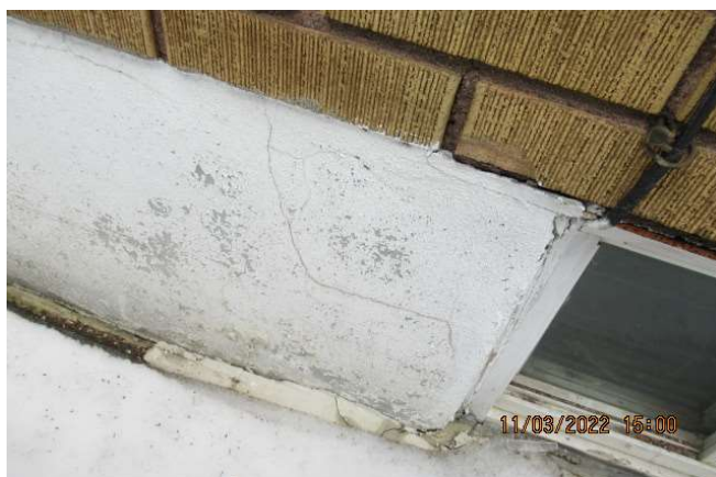
Fissures sur la fondation
