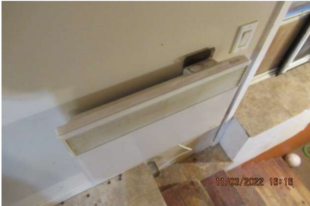
Aucune déficience apparente aux convecteur électriques
