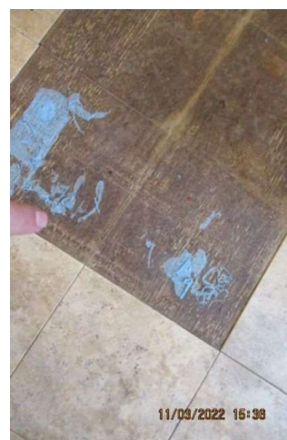
Domage du revêtement de sol
