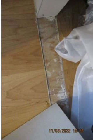
Joint de transition absent sur le plancher
