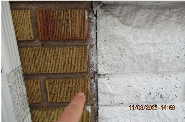
Fissures et ouverture dans le mortier
