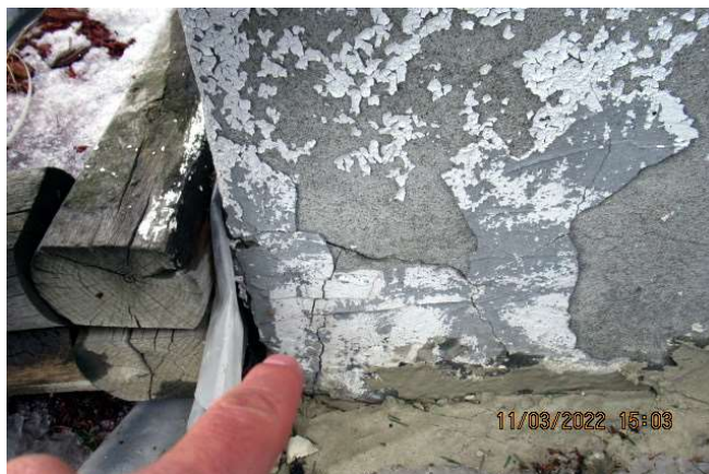
Fissures sur la fondation
