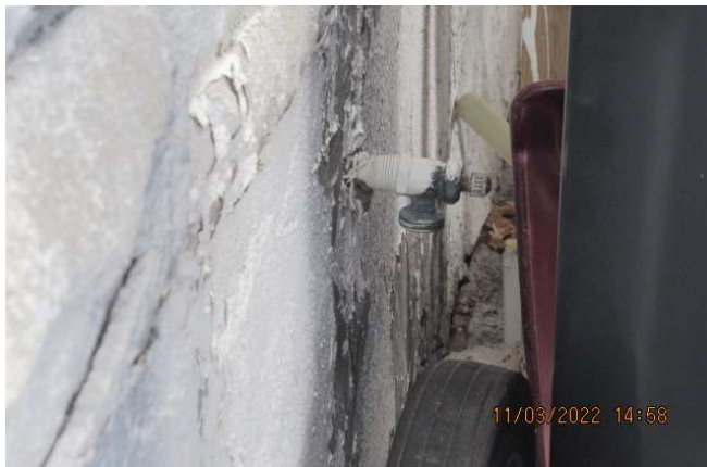
Robinet extérieur sans protection contre le gel
