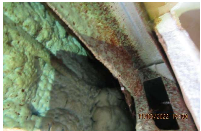
Cernes s'apparentant à de la moisissure sur l'isolant
