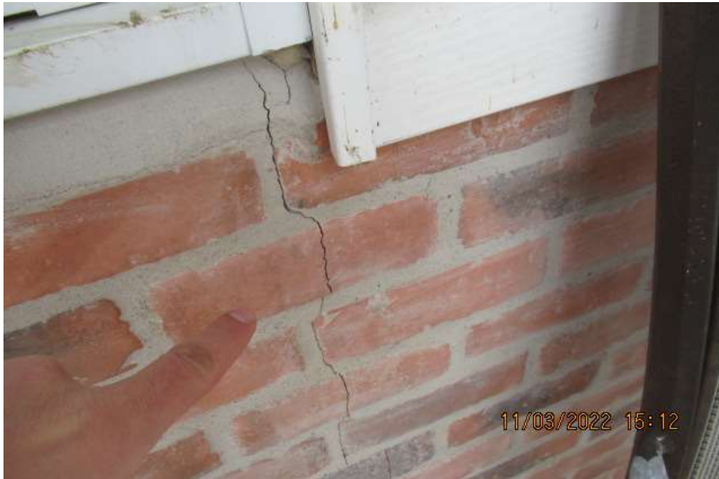
Fissures et ouverture dans le mortier
