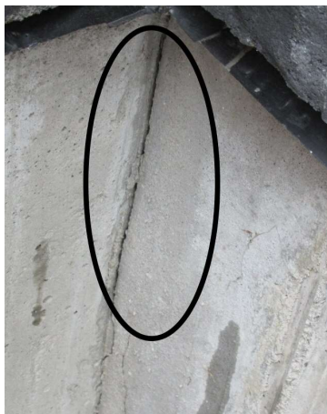
Minces fissures sur la fondation
