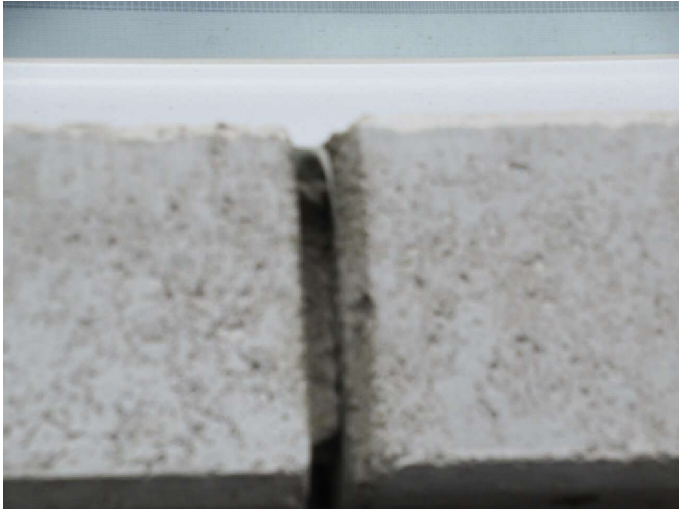
Fissure au joint de mortier
