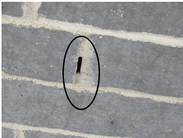
Mince fissure dans le mortier
