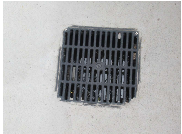
Drain de plancher
