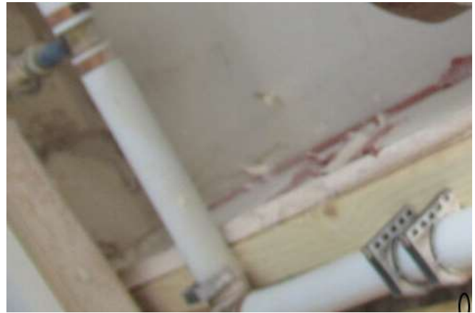
Coduites d'eau en PEX
