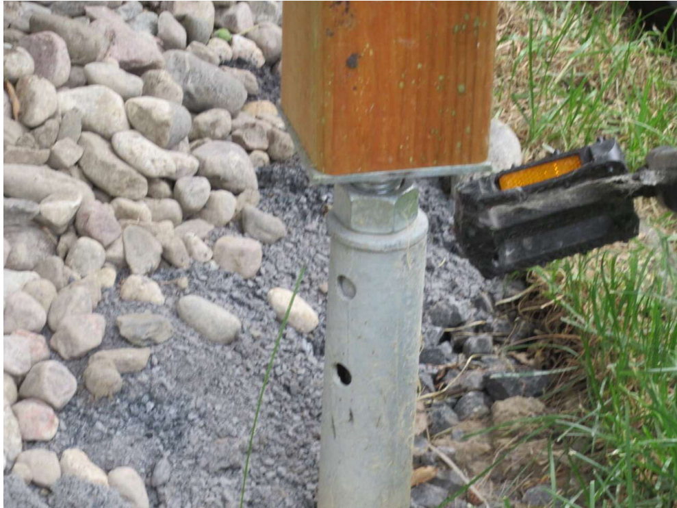
Aucune déficience apparente sur la terrasse
