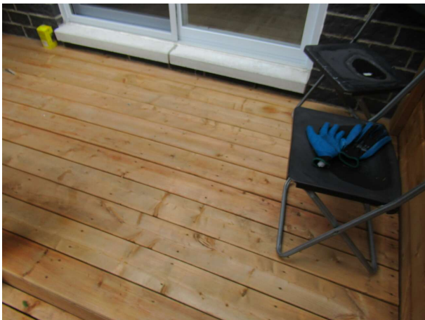
Aucune déficience apparente sur la terrasse
