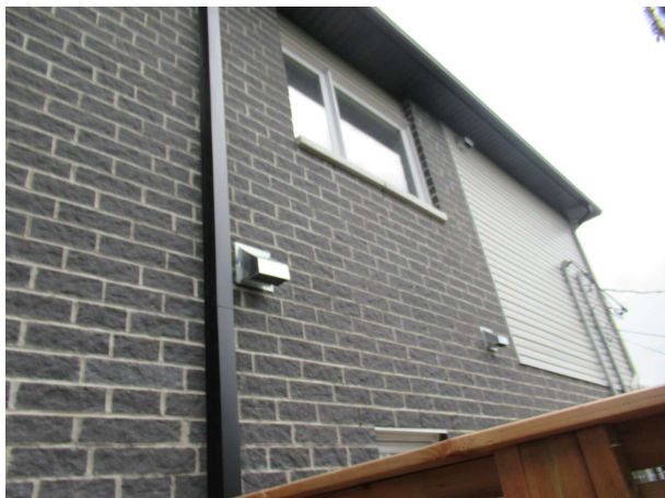
Hauteur excessive de la toiture
