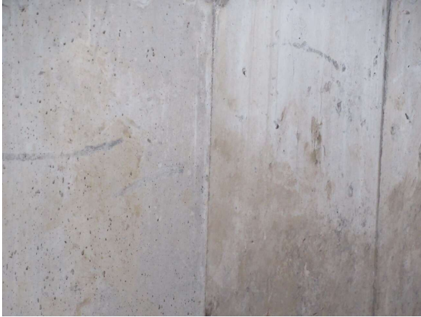
Fondation sans le crépi
