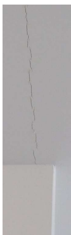
Fissure à la jonction de deux feuilles de gypse
