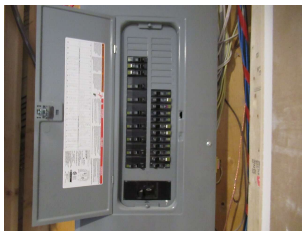
le coffret de distribution de l'unité de condominium au 223 rue Léo Longueuil appartenant à Mr Estevez Lizrazo Oscar
