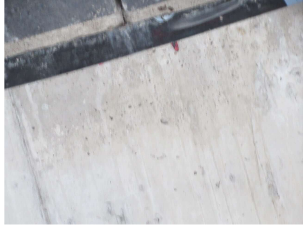
Fondation sans le crépi
