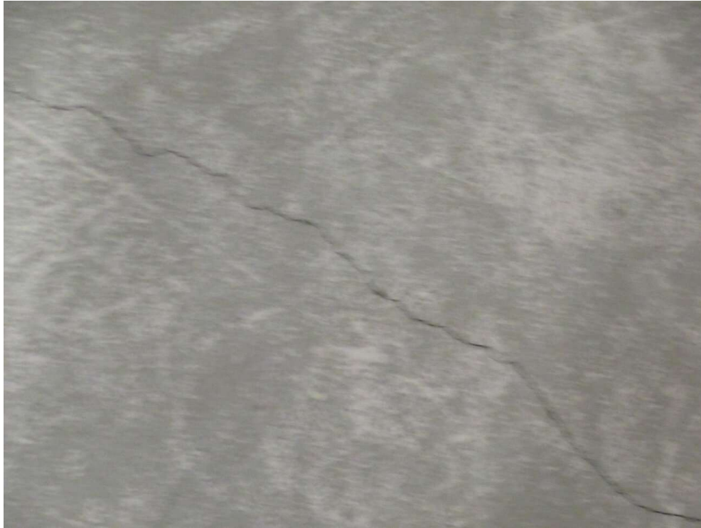
Fissures à la dalle de béton du sous-sol dans l'espace commun
