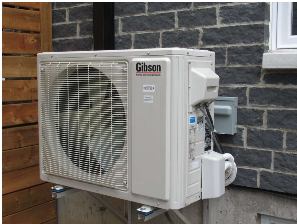
Limitation sur les systèmes de climatisation
