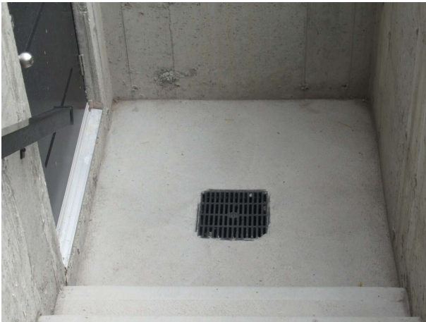
Drain de plancher
