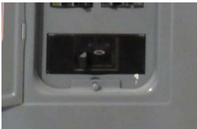
Aucune déficience au coffret de branchement électrique
