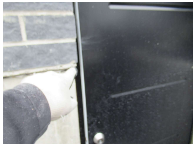
Porte scellée à l'uréthane non protégé
