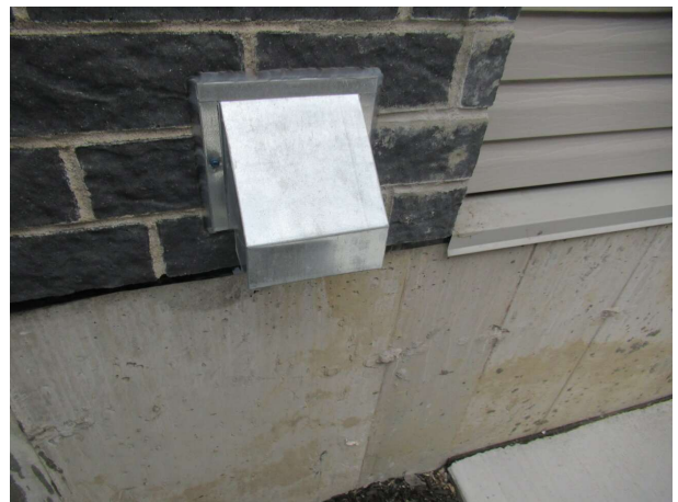
Conduit d'évacuation de la sècheuse en acier
