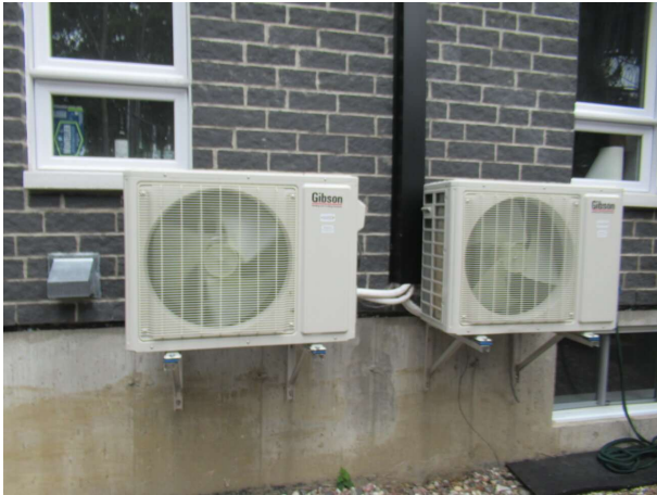
Limitation sur les systèmes de climatisation
