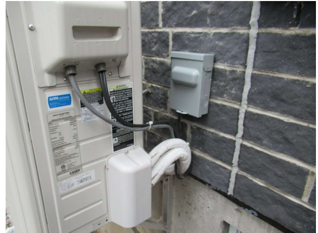
Limitation sur les systèmes de climatisation
