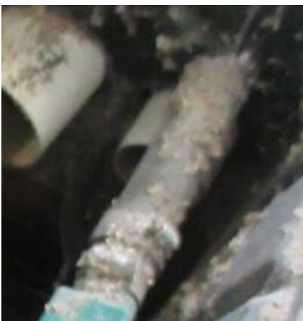
Conduits en ABS
