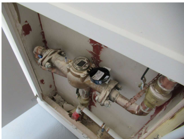
Mise à la terre non-visible sur l'entrée d'eau
