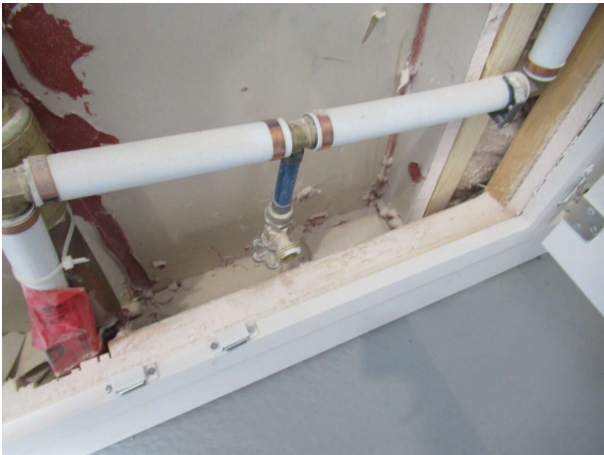
Coduites d'eau en PEX
