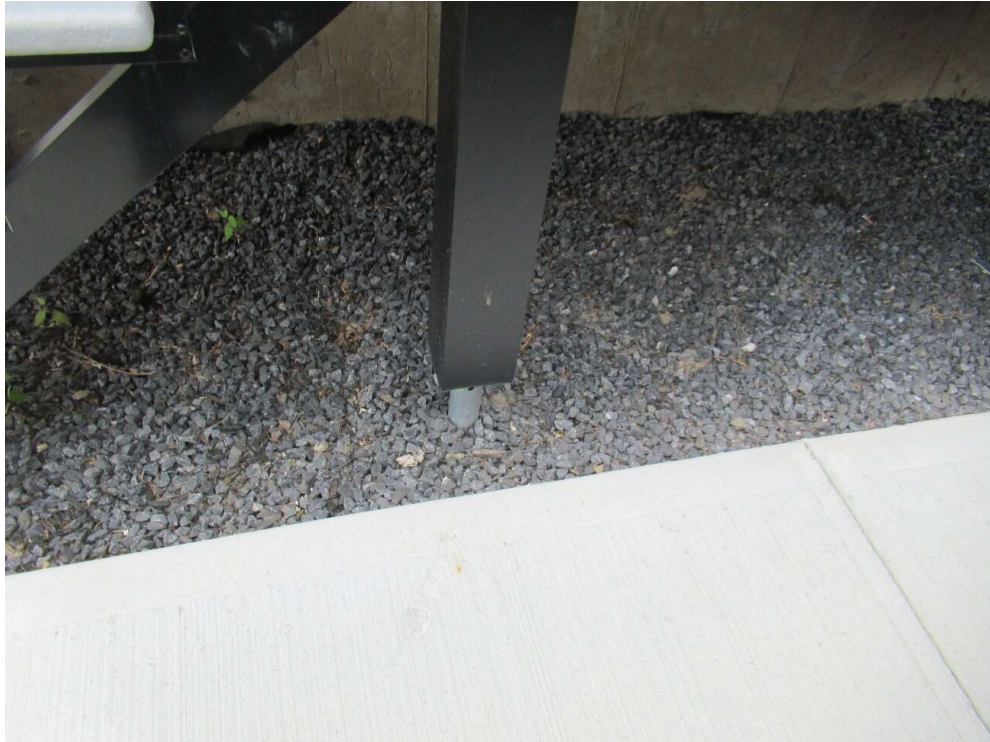
Aucune déficience apparente sur la terrasse
