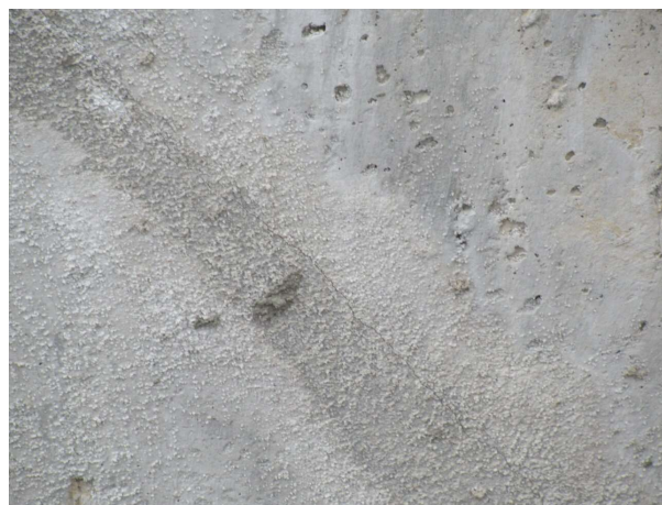
Fissure réparée sur la fondation
