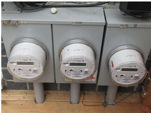
Compteur manquant pour la consommation énergétique de l'espace commun
