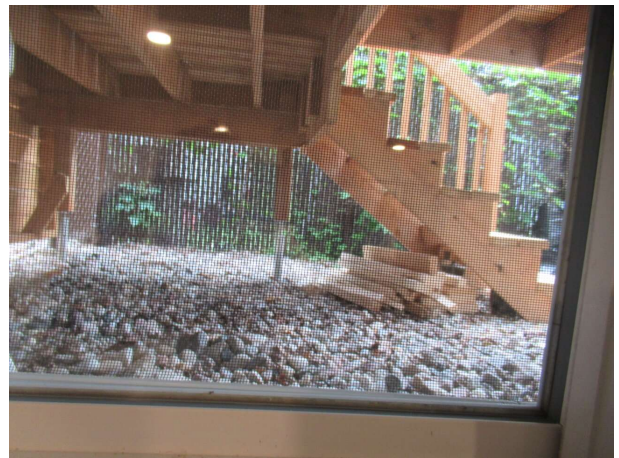
Aucune déficience apparente sur la terrasse
