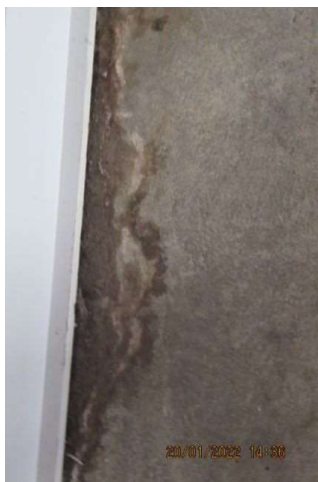
Signe d'infiltration d'eau
