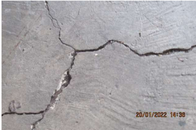
Fissure à la dalle de béton décalée
