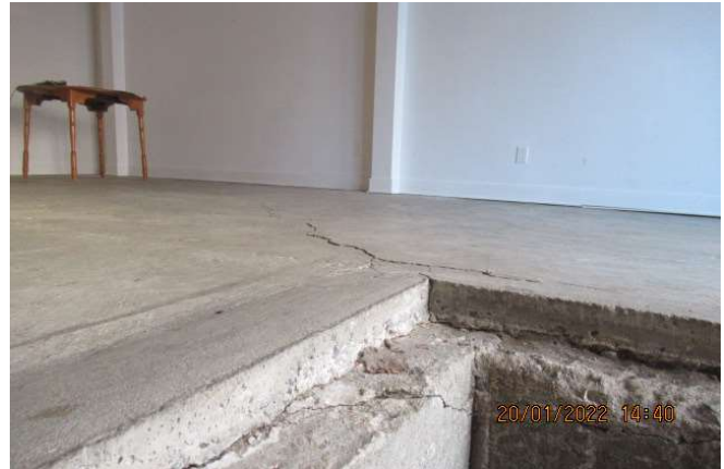
Fissure à la dalle de béton décalée
