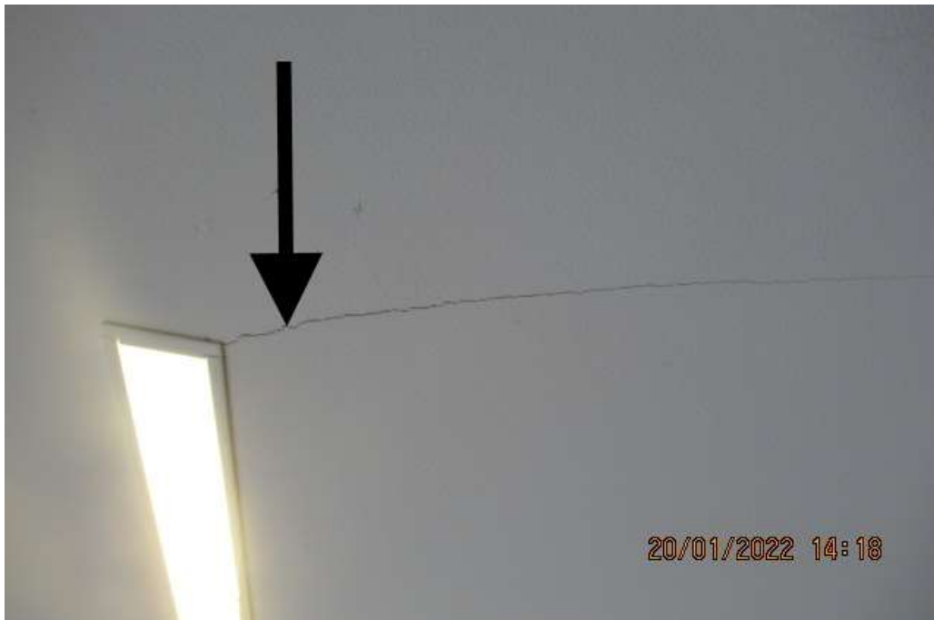
Fissures sur le plafond de gypse
