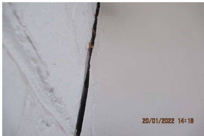
l'affaissement est la source de dommages à la structure du bâtiment, et à engendré des bris aux revêtements (plafonds, planchers, murs)
