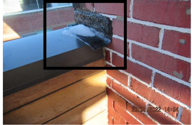
Solins de toit de jonction extensionnés à cause des mouvements structuraux
