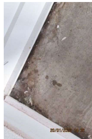
Signe d'infiltration d'eau
