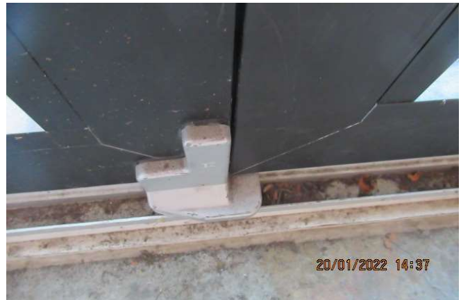
Portes extérieures qui ne sont pas à l'équerre et non opérationnelles dû à un mouvement structural
