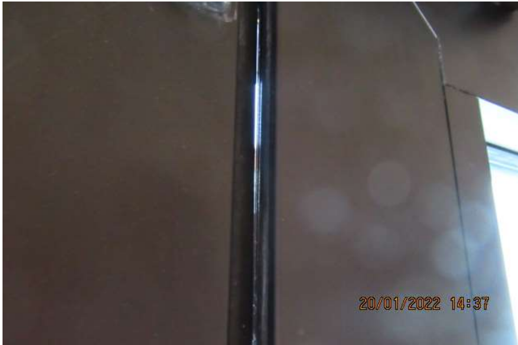
Portes extérieures qui ne sont pas à l'équerre et non opérationnelles dû à un mouvement structural
