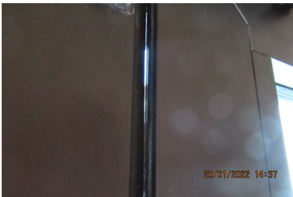
Porte non opérante causée par le mouvement de structure
