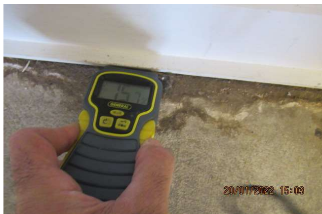
Indices d'infiltration d'eau
