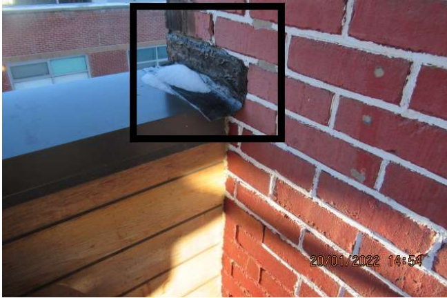
Solins de toit de jonction extensionnés à cause des mouvements structuraux
