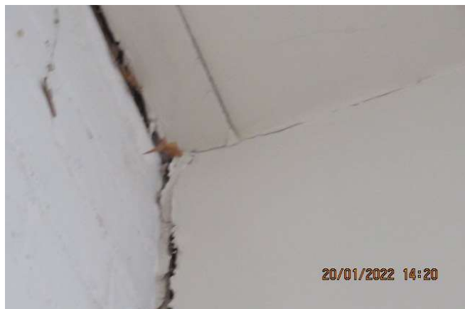
l'affaissement est la source de dommages à la structure du bâtiment, et à engendré des bris aux revêtements (plafonds, planchers, murs)
