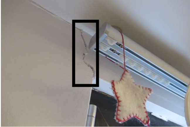
Fissures sur le mur de gypse
