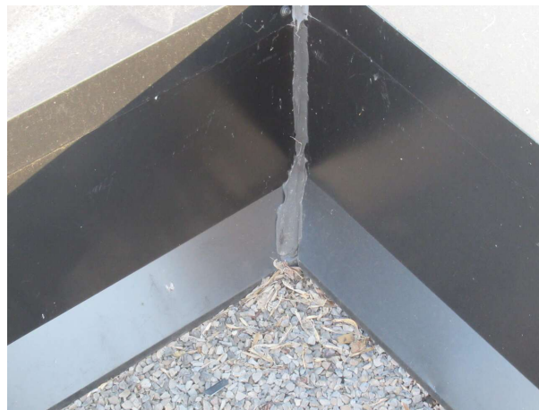
Toiture en bitume et gravier à entretenir
