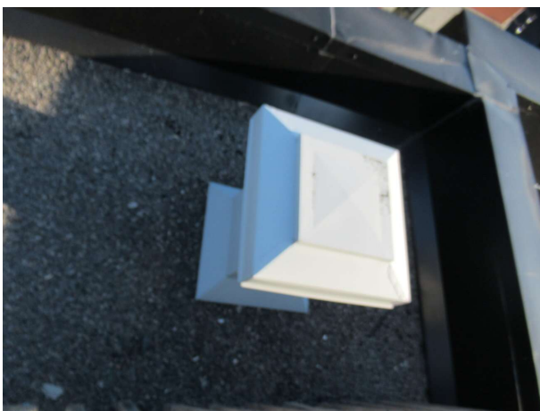
ventilateur de type maximum sur le toit plat
