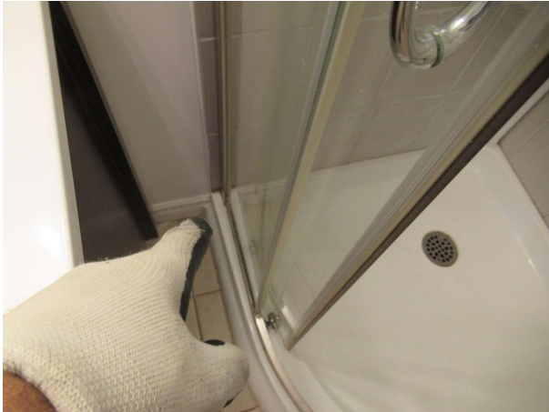
Joint de la douche
