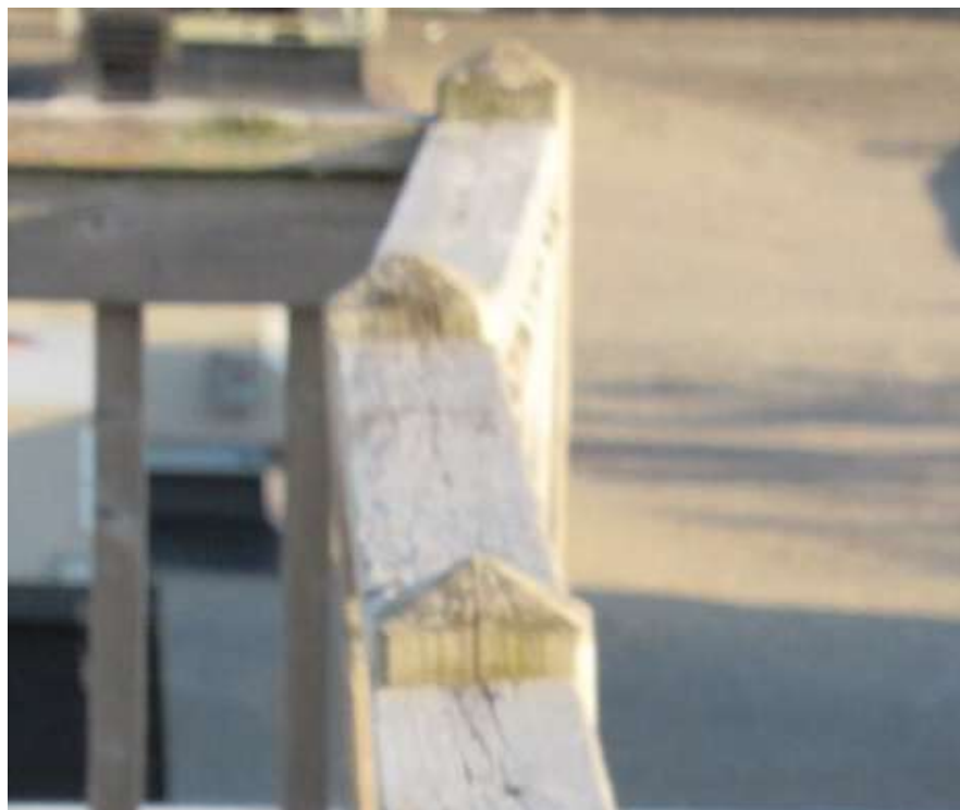
Balustrade et main-courante mal fixée
