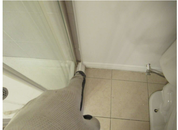
Joint de la douche
