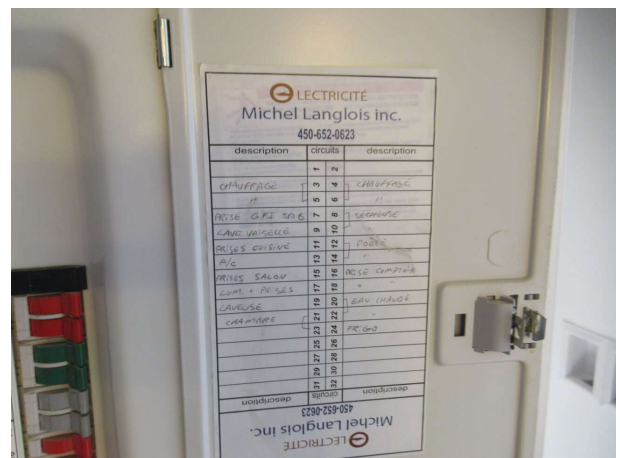
Assignation des disjoncteurs
