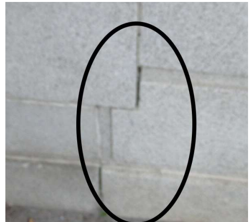
Fissures dans le mortier
