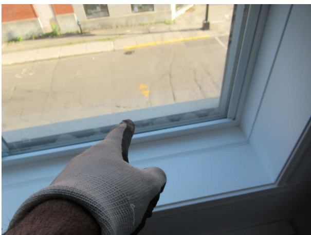
Fenêtres dont le double vitrage est descellé
