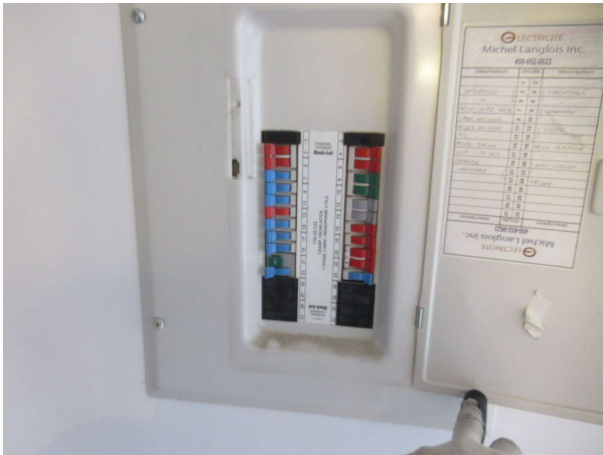
Nature du câblage électrique non confirmé
