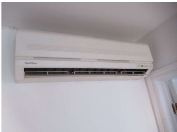
Aucune déficience apparente du distributeur mural ventilations de la climatisation
