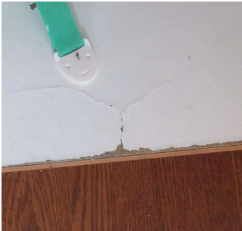
Revêtement de finition endommagé dans l'armoire
