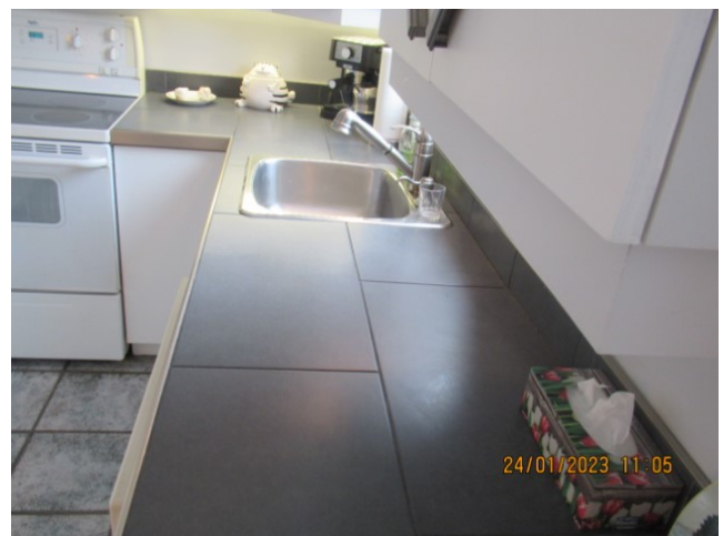
Comptoirs et armoires sans dommages significatifs
