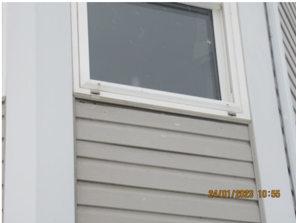
Scellant au pourtour des ouvertures à entretenir
