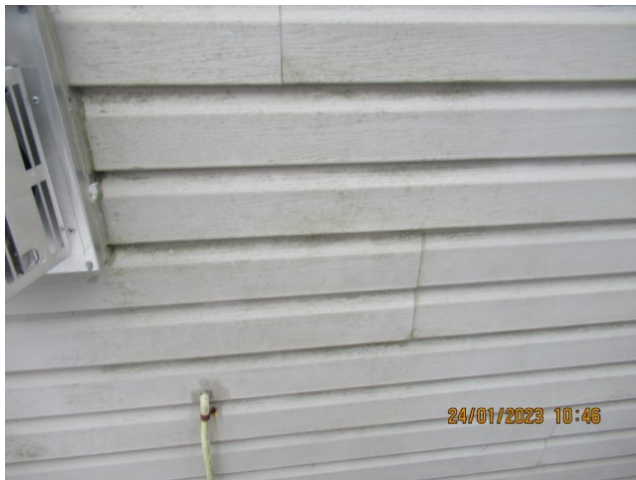
Revêtement extérieur à nettoyer
