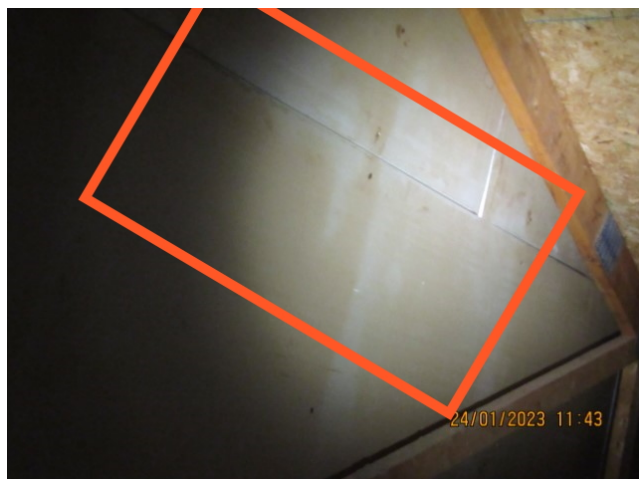
Trace d'eau et cerne sur le mur mitoyen au comble
