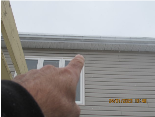
Ouverture et dommage dans le revêtement de clin de vinyle
