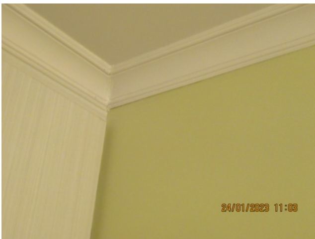
Limitation - Revêtement de gypse sur les murs porteurs
