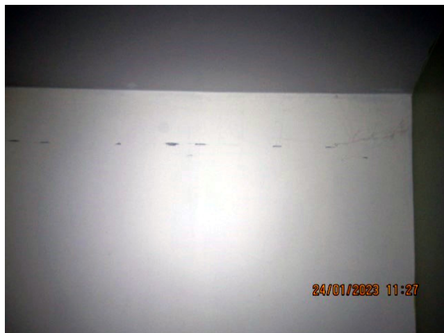
Revêtement de finition endommagé
