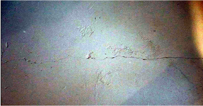
Mince fissure à la dalle de béton
