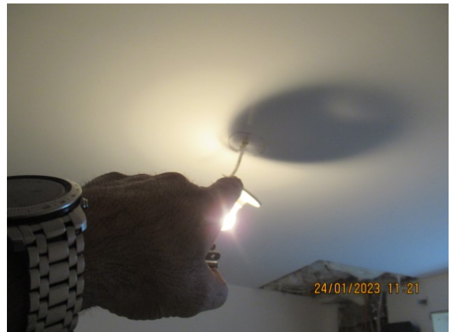
Luminaire mal fixé
