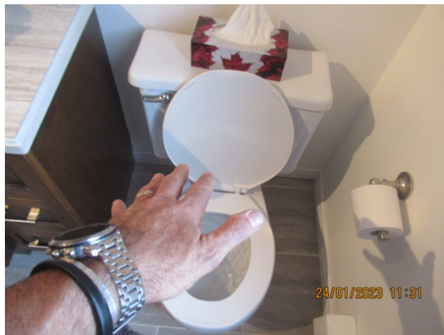
Toilette instable sur son socle
