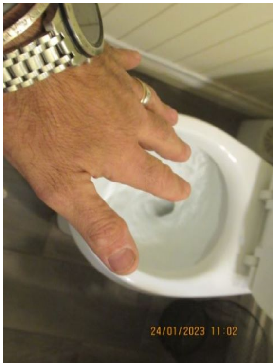
Toilette instable sur son socle
