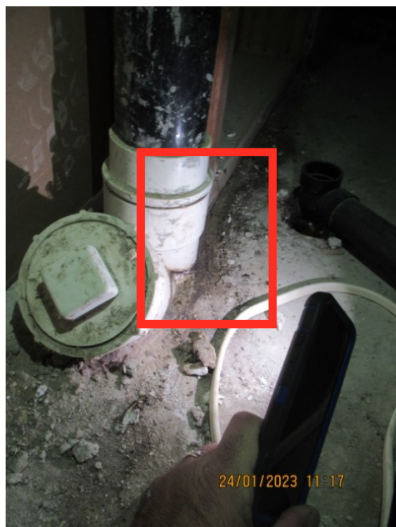
Tuyau d'évacuation des eaux qui fuit
