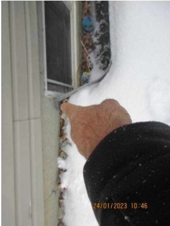
Margelle de la fenêtre non fixée
