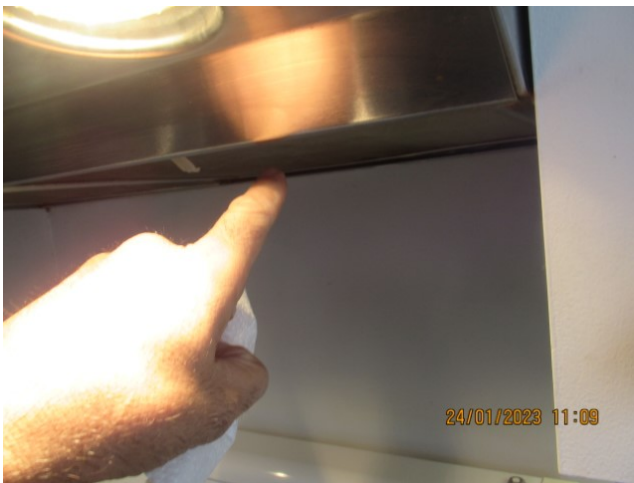
Ventilateur de cuisine inefficace
