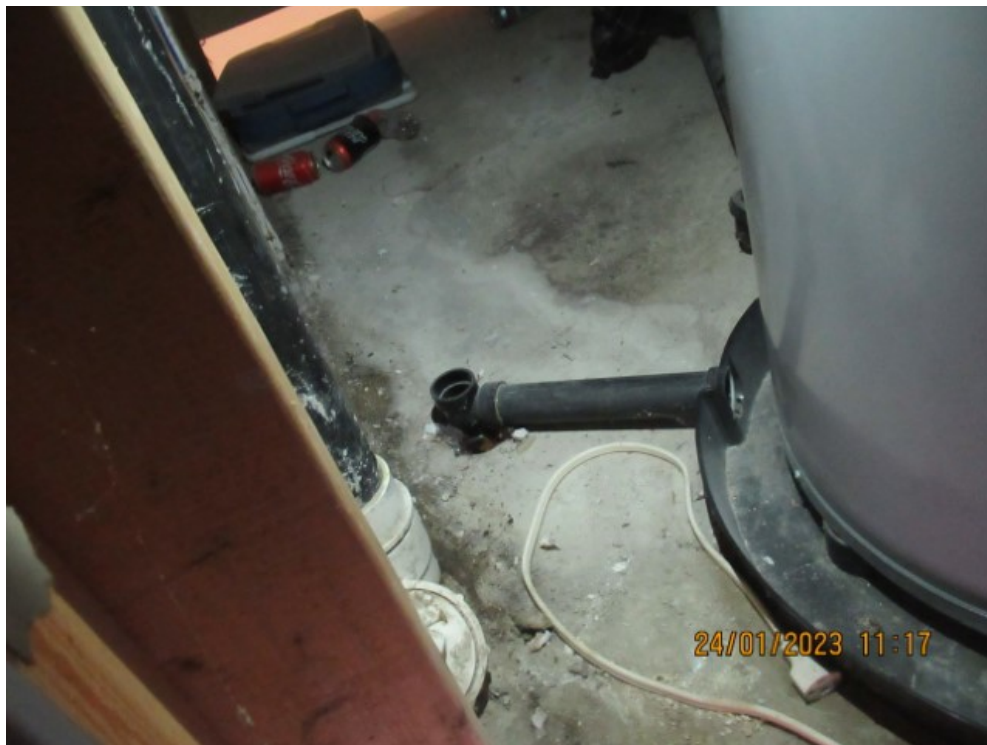
Aucune déficience observée sur le chauffe-eau
