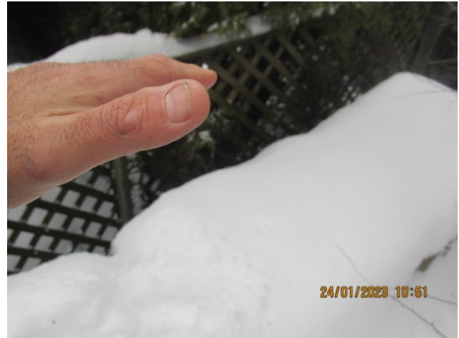
Muret de soutènement qui s'affaisse
