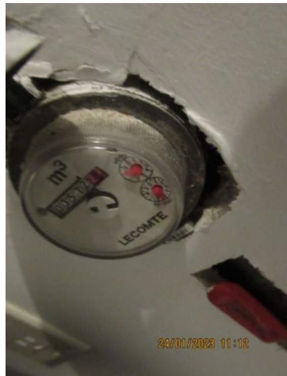
Mise à la terre non observée sur l'entrée d'eau principal
