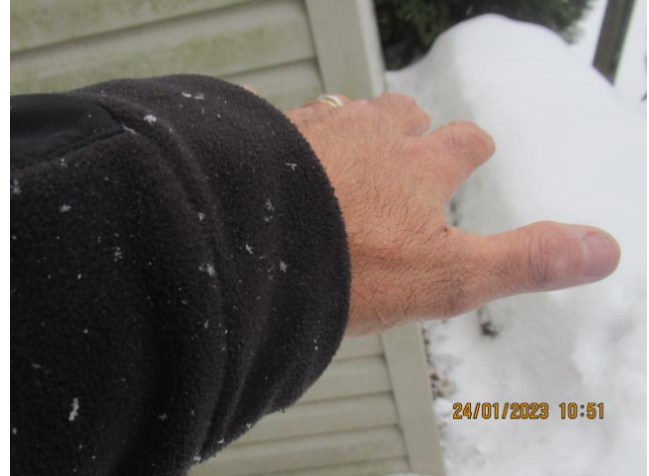
Pente de sol négative drainant vers le bâtiment
