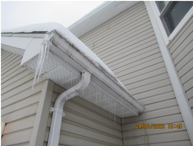
Defficiency de ventilation dans l'entretait
