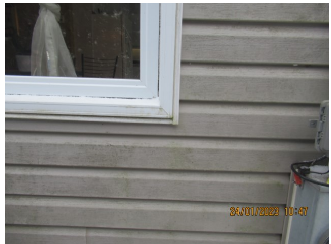
Revêtement extérieur à nettoyer
