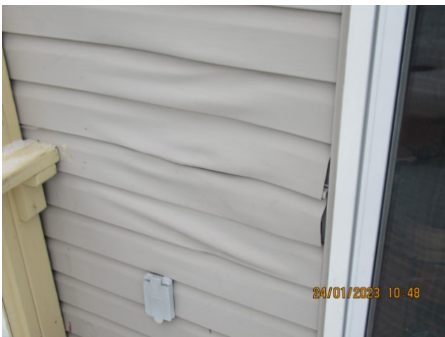
Revêtement extérieur de vinyle endommagé
