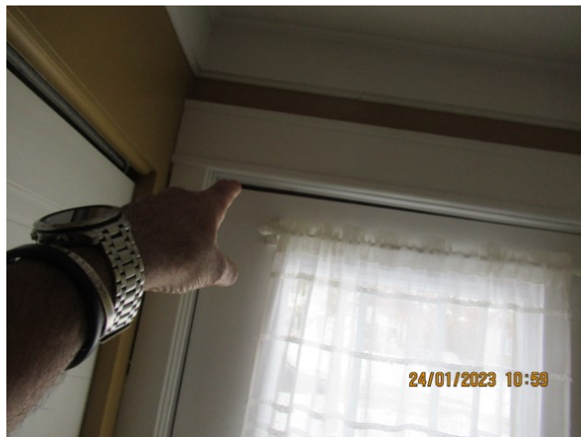
Porte extérieure qui n'est pas à l'équerre
