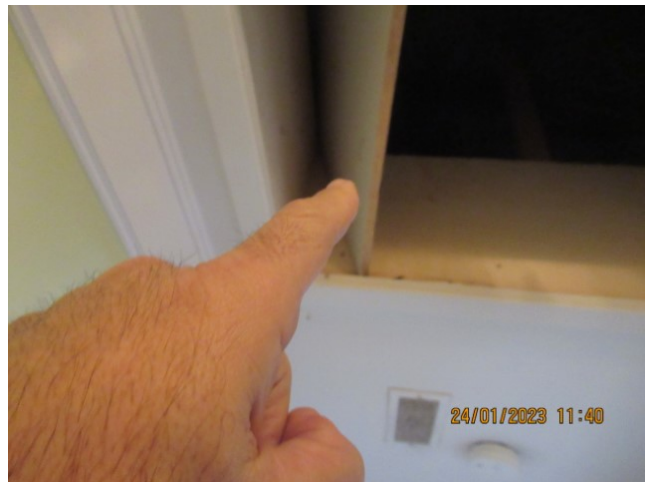
Trappe d'accès mal scellée et mal isolée
