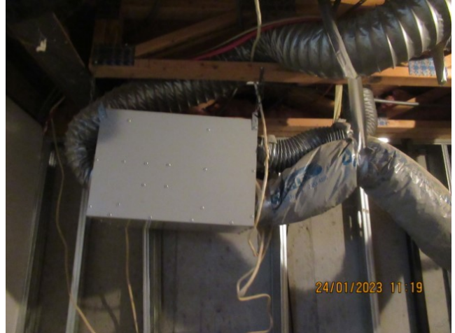
Conduit de ventilation mal scellé et mal fixé
