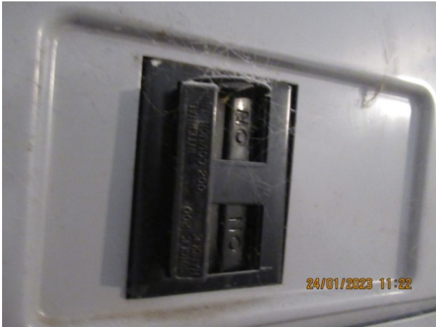
Aucune déficience au coffret de branchement électrique
