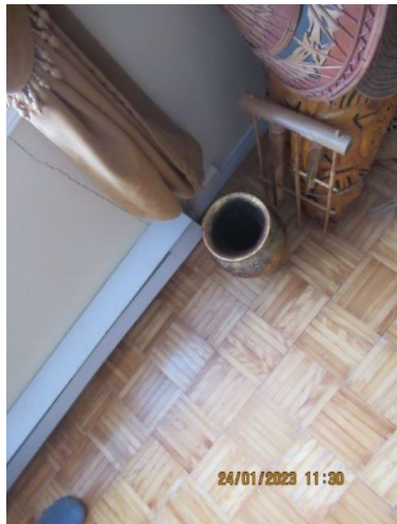
Dégagement avec les rideaux insuffisant
