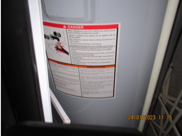
Aucune déficience observée sur le chauffe-eau
