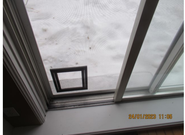
Porte coulissante en PVC à entretenir
