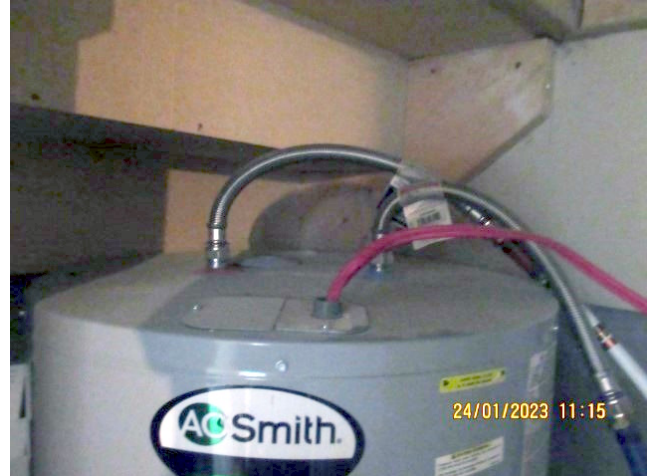
Aucune déficience observée sur le chauffe-eau
