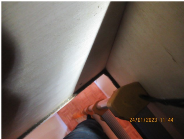
Trappe d'accès mal scellée et mal isolée
