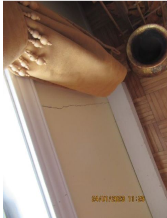
Fissure sur le mur
