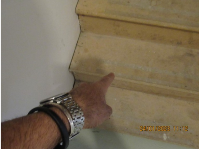
Escalier en bois sans finition de protection
