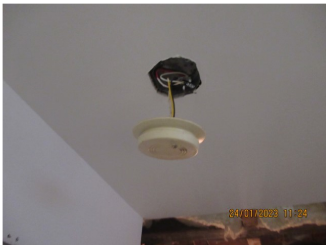
Avertisseur de fumée mal installé
