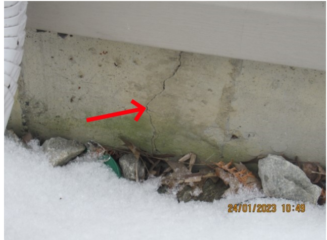
Fissure à réparer sur la fondation
