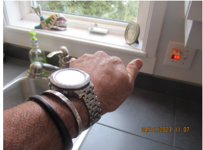
Prise DDFT requise près d'un source d'eau
