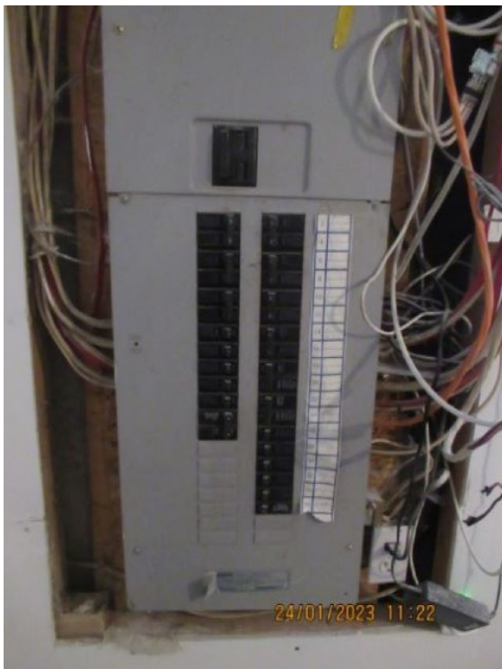
Fiche d'assignation des disjoncteurs absente ou incomplète
