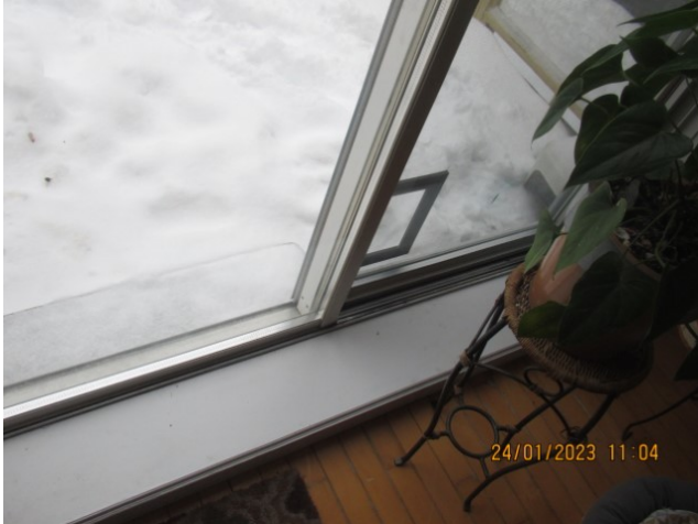
Porte coulissante en PVC à entretenir
