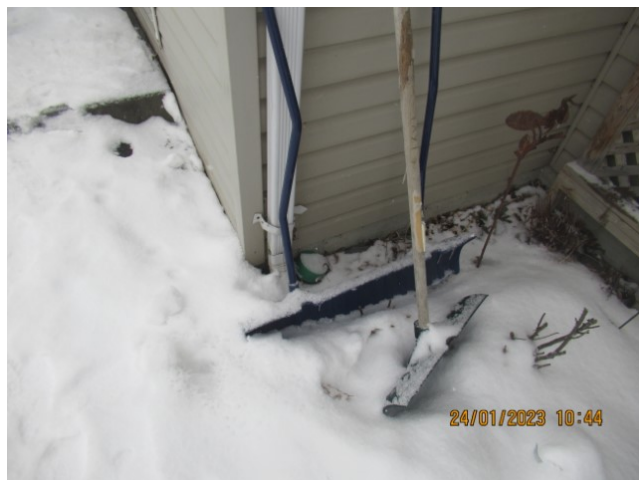
Revêtement extérieur trop près du sol
