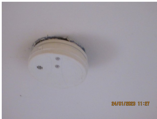
Avertisseur de fumée mal installé
