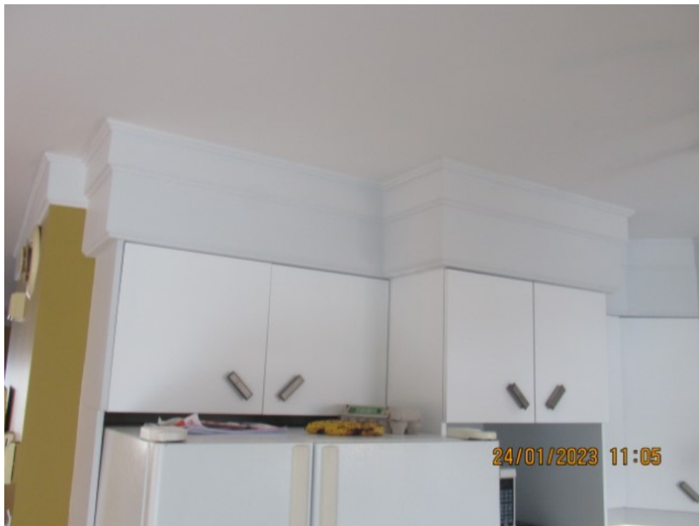
Comptoirs et armoires sans dommages significatifs
