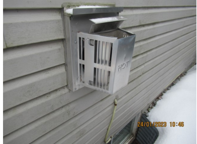
Scellant au pourtour des ouvertures à entretenir
