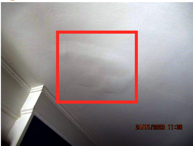
Cernes d'eau au plafond
