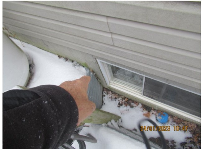
Margelle de la fenêtre non fixée
