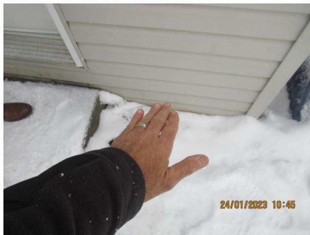
Revêtement extérieur trop près du sol
