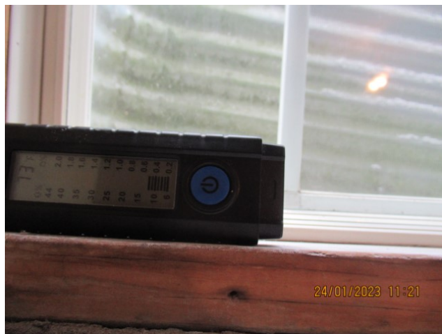
Taches et cernes au pourtour de la fenêtre
