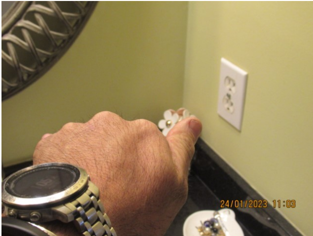
Prise DDFT requise près d'un source d'eau
