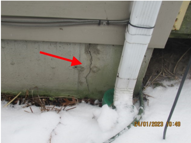
Fissure à réparer sur la fondation
