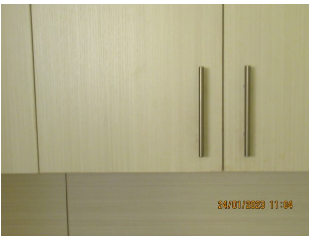
Comptoirs et armoires sans dommages significatifs
