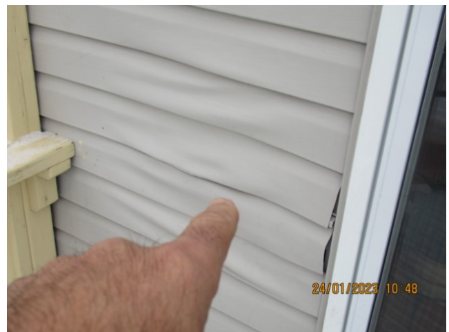
Revêtement extérieur de vinyle endommagé
