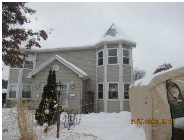
Toiture inaccessible (hauteur excessive et pente abrupte)
