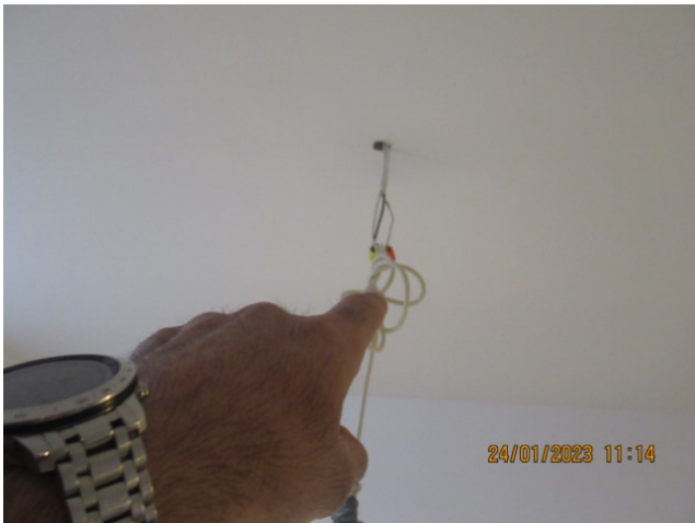
Raccordement électrique artisanale
