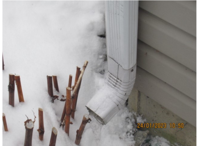
Descentes pluviales qui évacuent trop près de la fondation
