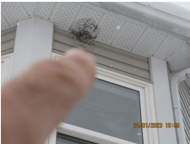
Nid de guêpes sur les soffites
