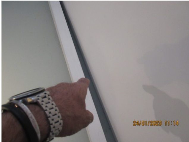
Plinthe électrique mal fixée
