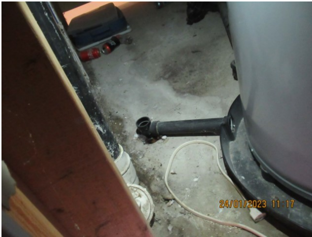
Drain de plancher sans grillage de protection
